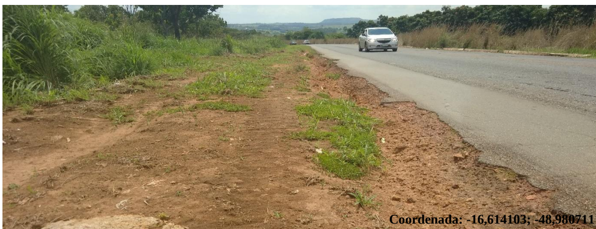
Figura 22. Área 6, fissura no alinhamento do acostamento, Bonfinópolis
