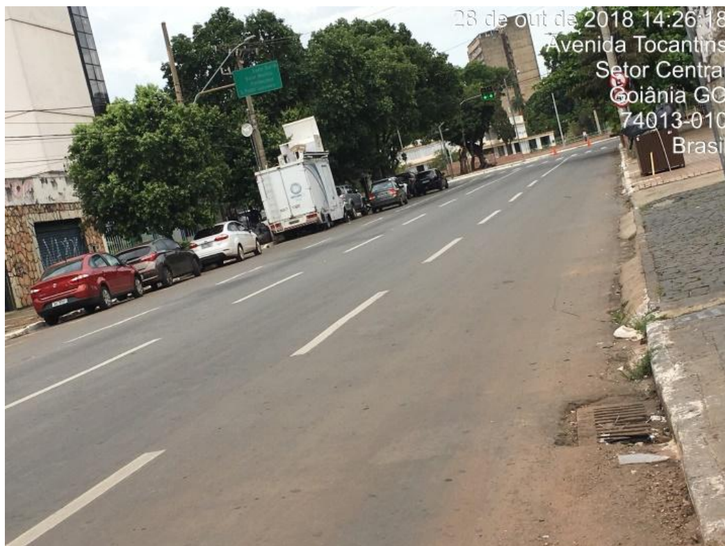
Figura 8 - Sinalização (Avenida Tocantins – Setor Central)
