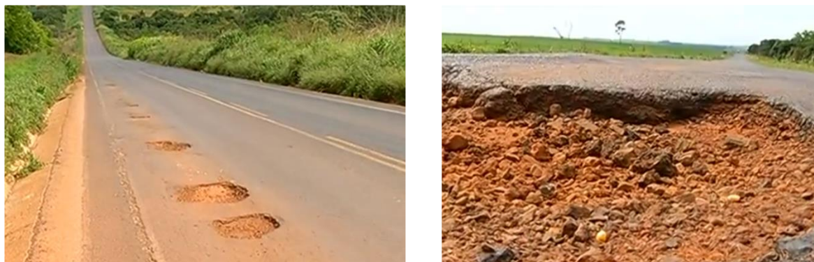
Figura 14 e 15. Patologias em Trechos da GO 174, Rio Verde - GO.
