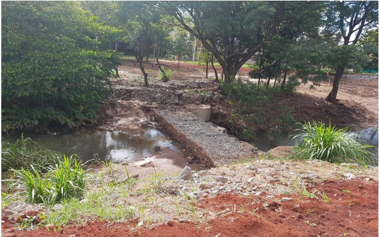
Figura 4. Barramento de contenção e nível com assoreamento acumulado a montante.
