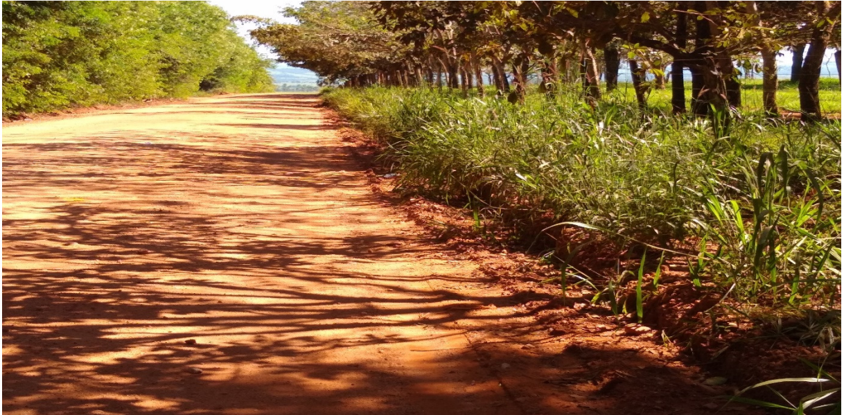
Figura 3. Valeta na estrada vicinal
