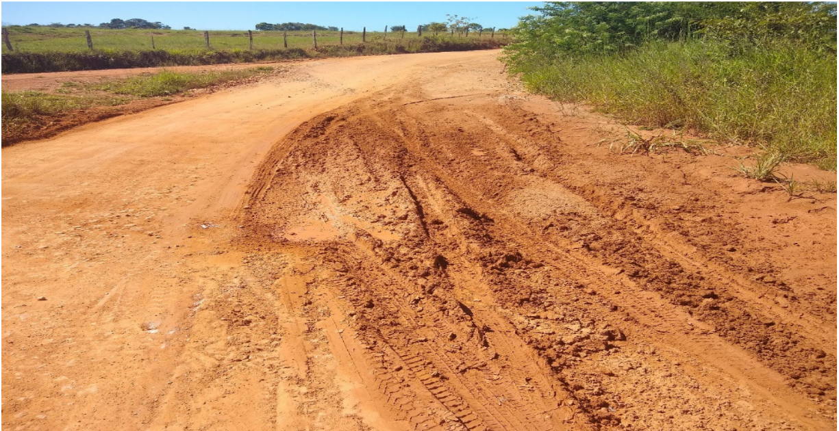
Figura 5. segregação de agregados.
