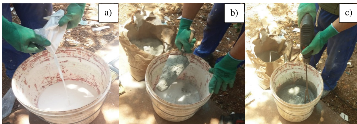
Figura 8. Preparação do impermeabilizante para aplicação; a) parte líquida; b) parte em pó; c) mistura dos componentes.
