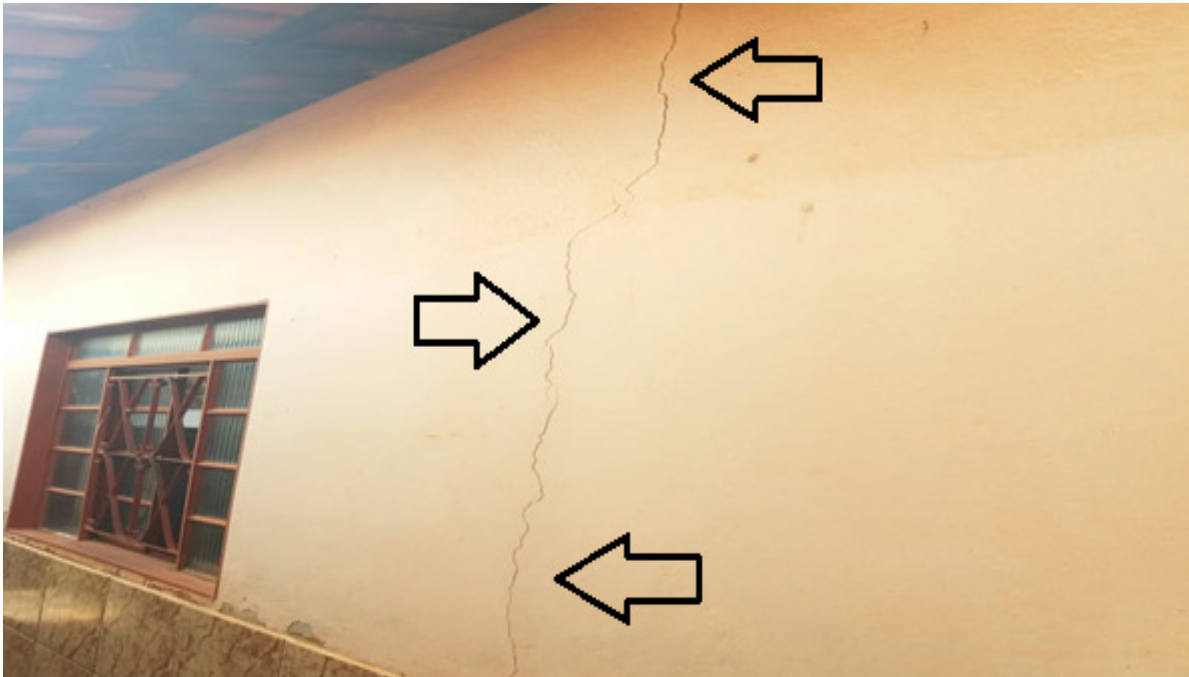
Figura 5. Trinca em parede externa.
