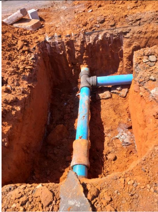
Figura 11 TRECHO MANUTENÇÃO DE ÁGUA.
