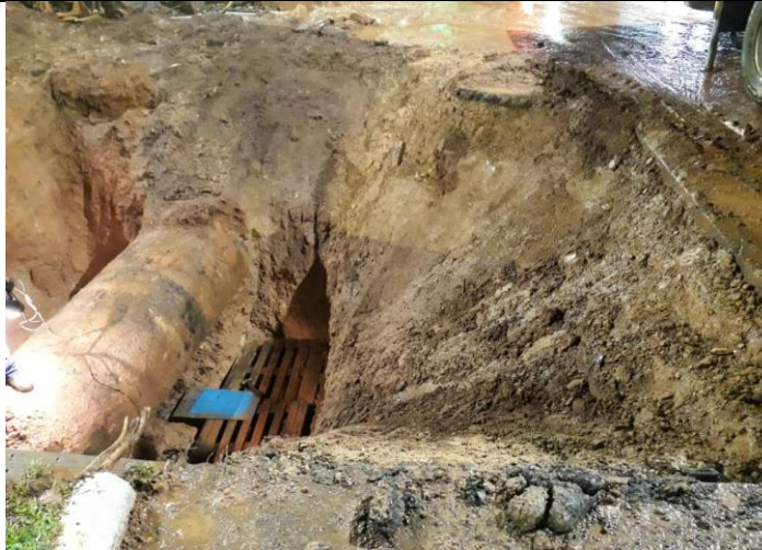
Figura 5: TRECHO MANUTENÇÃO DE ÁGUA GOIÂNIA
