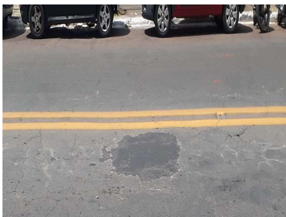
Figura 5 : Remendo Superficial. Fonte: RABELO (2019).
