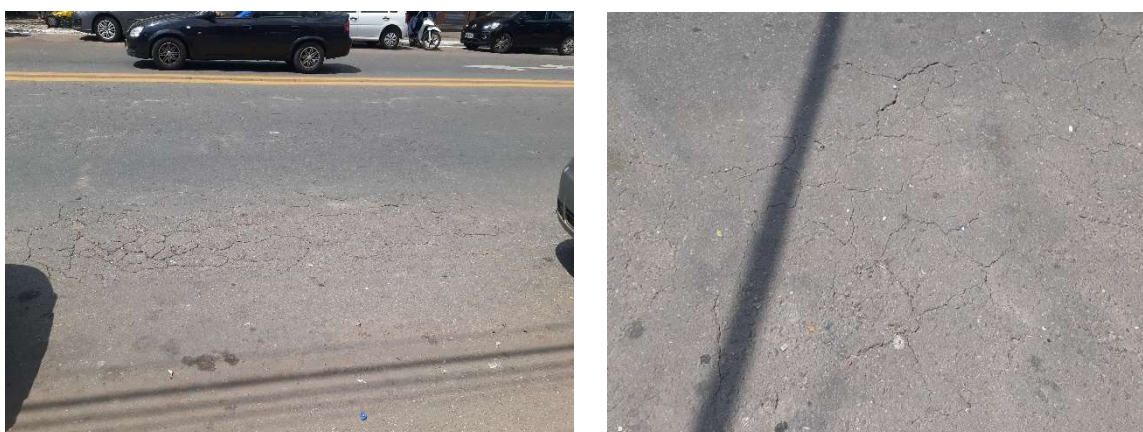
Figuras 2 (a e b) : Trinca tipo “Couro de Jacaré”. Fonte: RABELO (2019).
