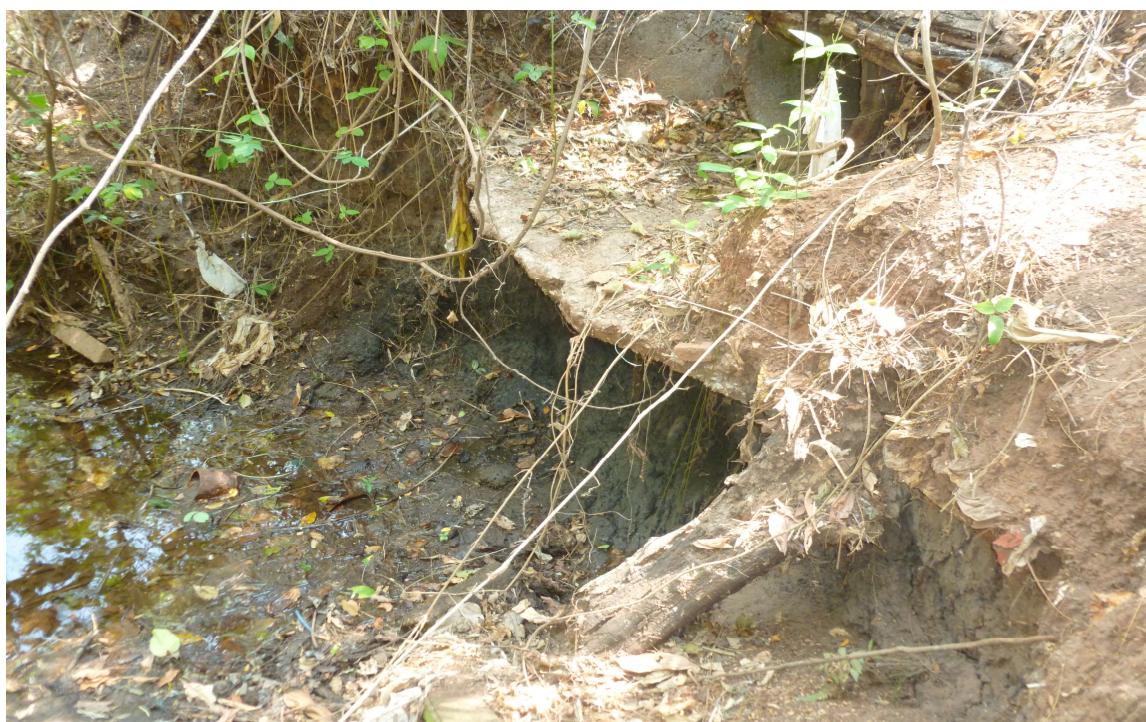
Figura 18. Erosão Pluvial as margens do Córrego Fundo.
