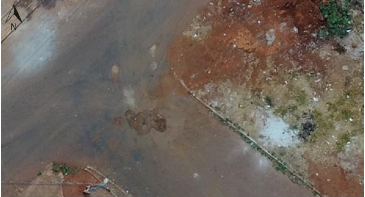
Figura 12. Via pavimentada com patologia, sem vetorização.
