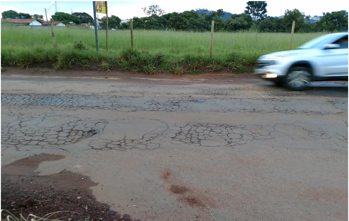
Figura 05: Patologias no pavimento.
