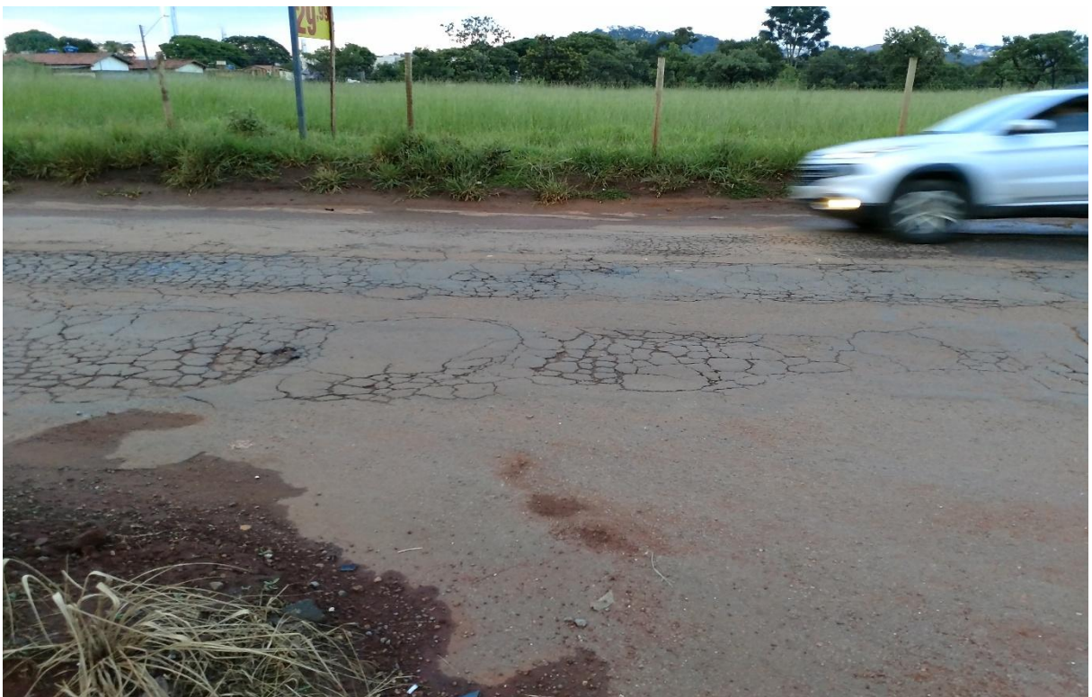
Figura 14: Patologias no pavimento.
