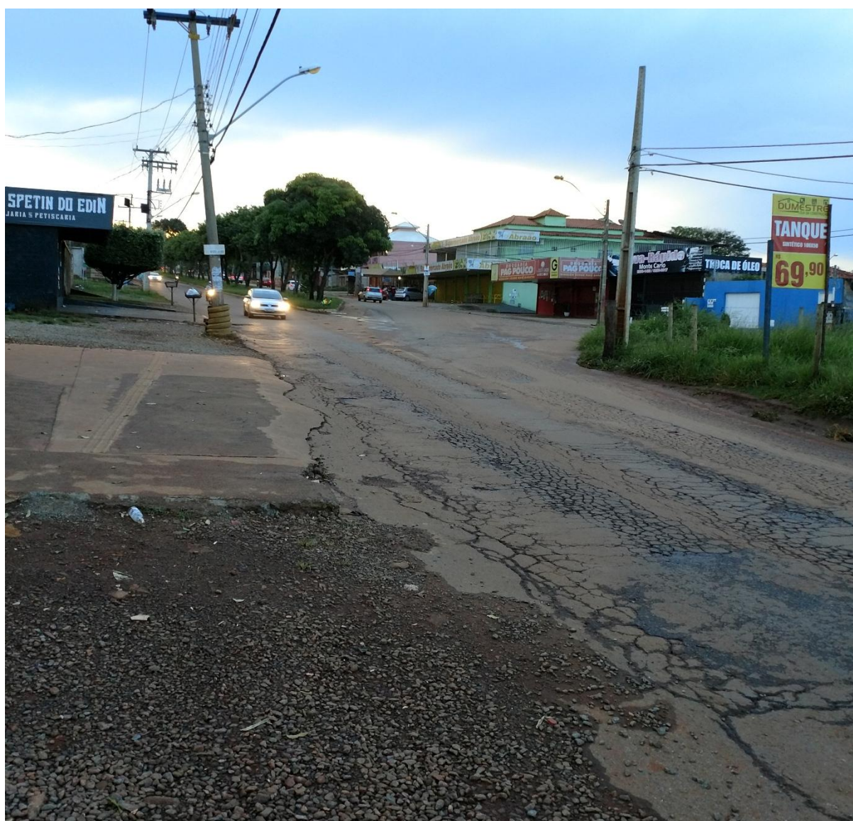
Figura 15: Ausência parcial de calçadas.
