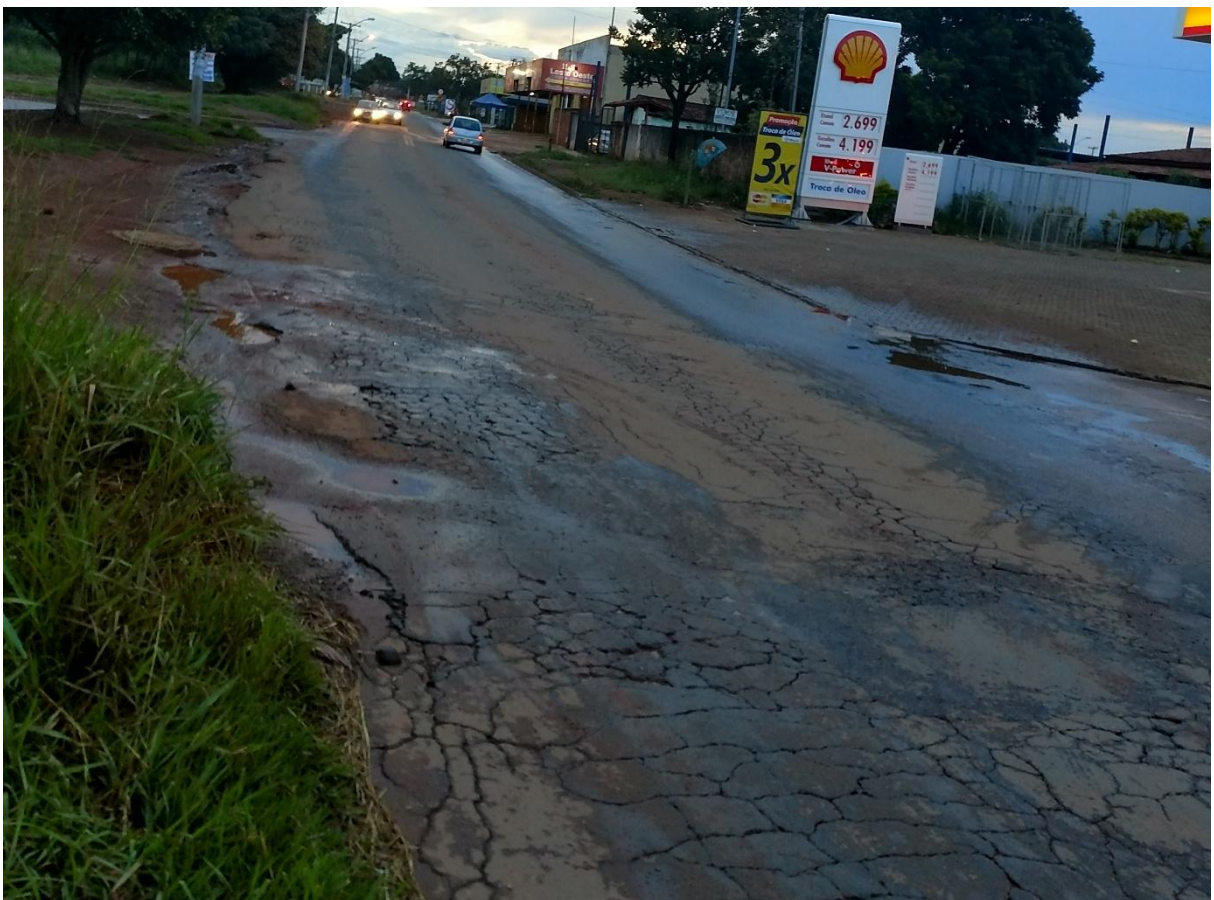
Figura 06: Patologias no pavimento.
