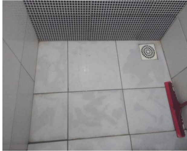
Foto 16 - Infiltração de água em revestimento cerâmico na Suíte.
