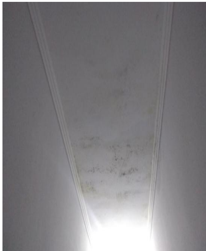
Foto 17 - Bolor em teto do corredor.
