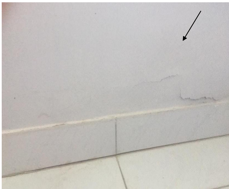
Foto 18 – Trinca acima do rodapé na sala.
