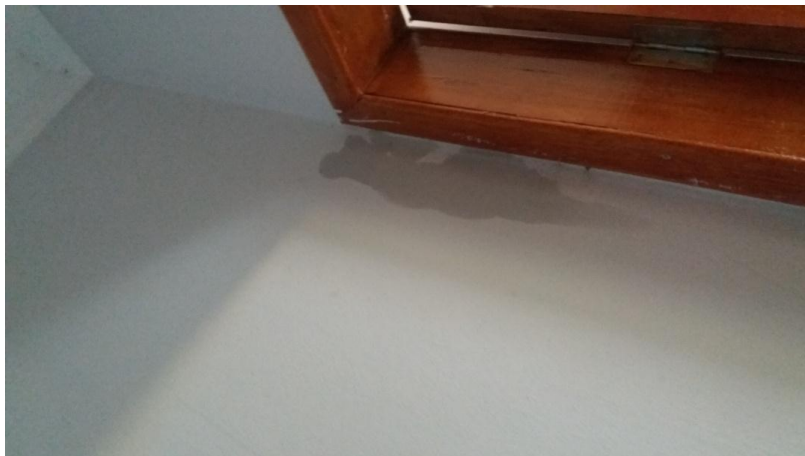
Foto 12 – Infiltração em parede interna em portal do quarto com suíte.
