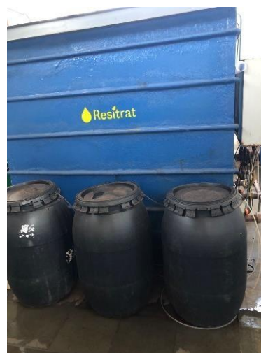
Figura 6 - Vista dos Tambores Químicos (Reagentes).
