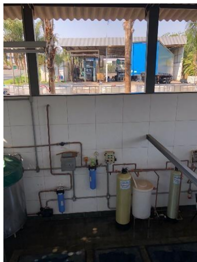
Figura 3 - Vista Sistema de Tratamento de Água.
