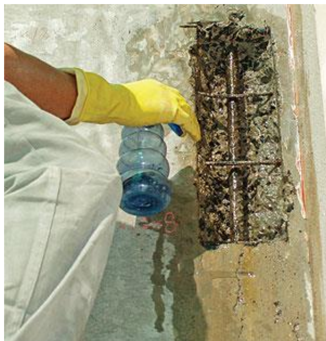
Figura 8 – Saturação do Concreto Fonte: http://techne17.pini.com.br/engenharia-civil/160/artigo287763-2.aspx
