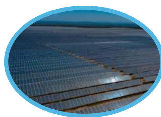
Usina fotovoltaica D'Roma
