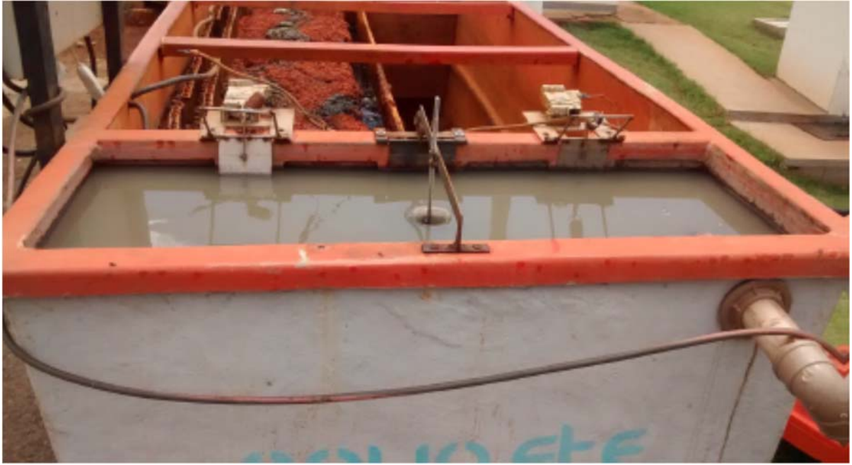
Figura 2. Detalhe da caixa primária do modelo piloto do módulo de tratamento por eletrólise. No lado esquerdo, a comporta de regularização de vazão de esgoto para a caixa eletrolítica. No centro da caixa primária, o extravasor da vazão excedente. Fonte: Próprios Autores, 2018
