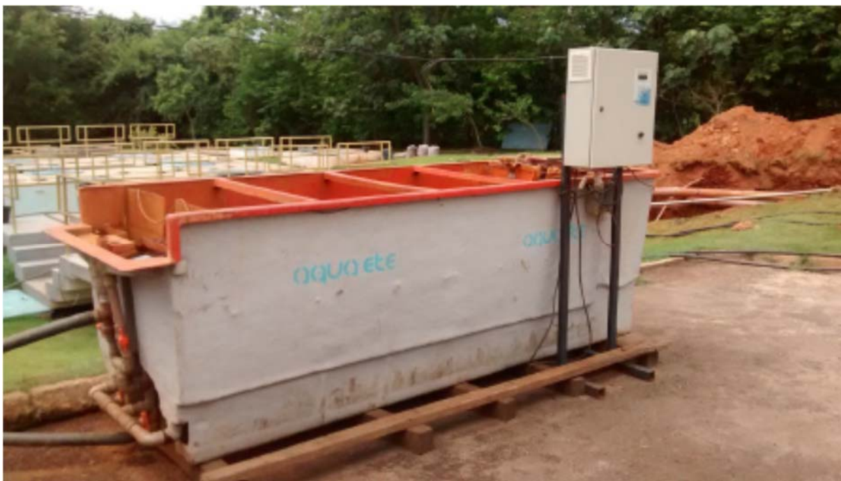
Figura 1. Vista geral do modelo piloto do módulo de tratamento de esgoto por eletrólise utilizado na ETE Terezópolis.
