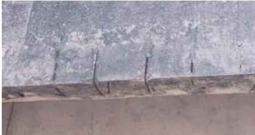
Figura 7 – Corrosão de armadura
