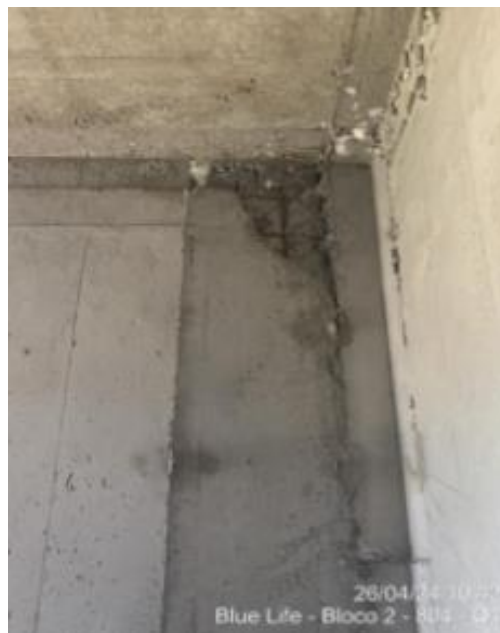
Figura 6 – Descolamento de concreto
