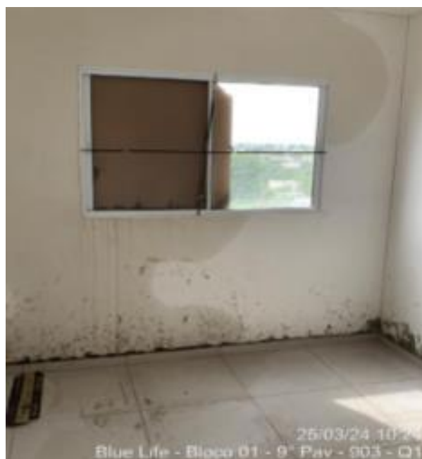
Figura 4 – Umidade em parede
