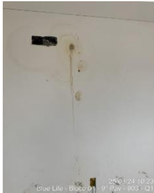
Figura 5 – Oxidação de armadura
