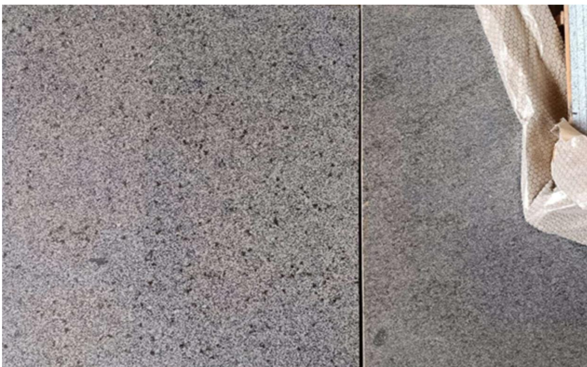
Figura 13 – Diferença de tonalidade do piso granito
