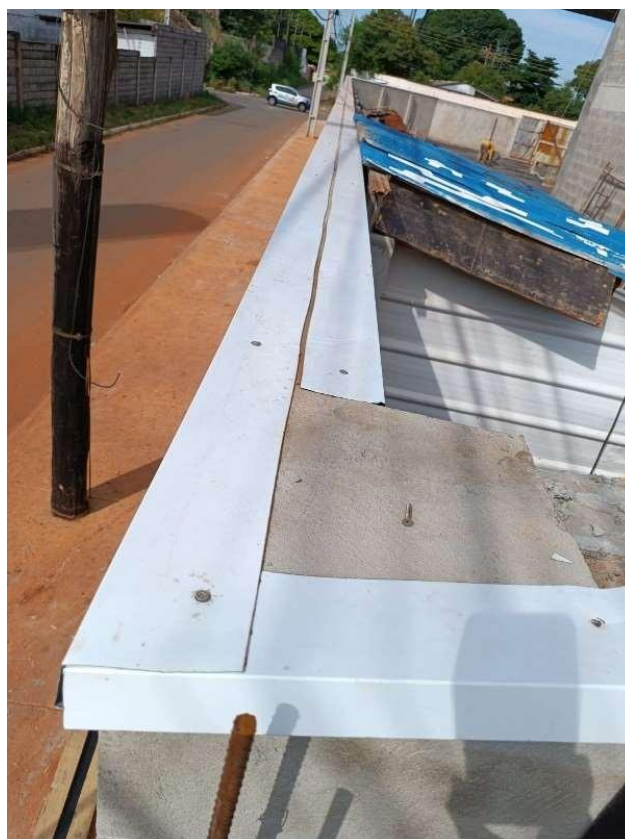
Figura 16 – Detalhe pingadeira metálica insatisfatória
