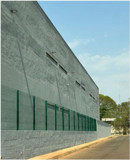
Figura 14 – Detalhe alvenaria com estética insatisfatória
