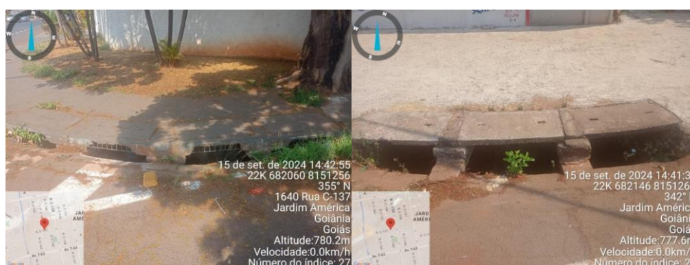
Figura 21 e Figura 22. Presença de resíduos e vegetação saindo das bocas de lobo, o que indica obstrução dos canais por excesso de sedimentos nos pontos 13 e 14
