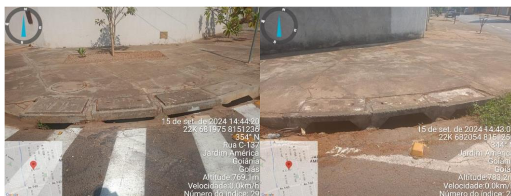
Figura 19 e Figura 20. Pontos 11 e 12 com repetição do problema de obstrução de entrada, porém com posicionamento adequado
