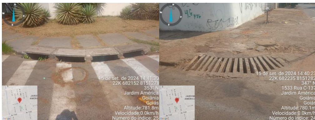
Figura 23 e Figura 24. Boas de lobo bem-posicionadas, com tampas adequadas e uso de bocas tipo grelha em pontos de maior demanda de engolimento, nos pontos 15 e 16
