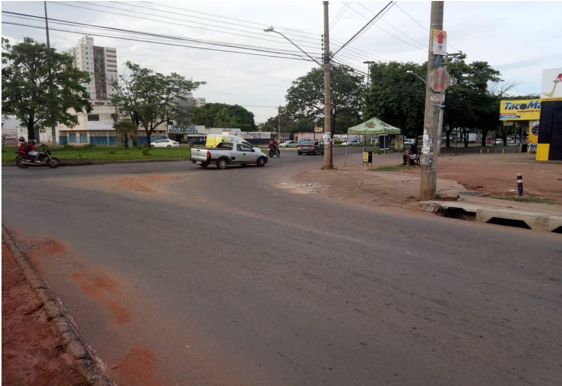
Figura 20. Ausência de sinalização horizontal aproximação "D" da Alameda Câmara Filho Fonte: Autoria própria
