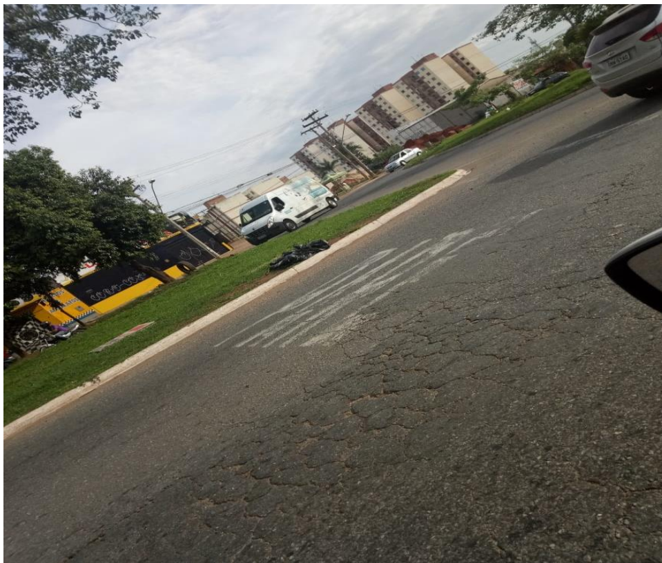
Figura 17. Sinalização horizontal apagada na aproximação ‘A’ Goiânia – Guapó Fonte: Autoria Própria
