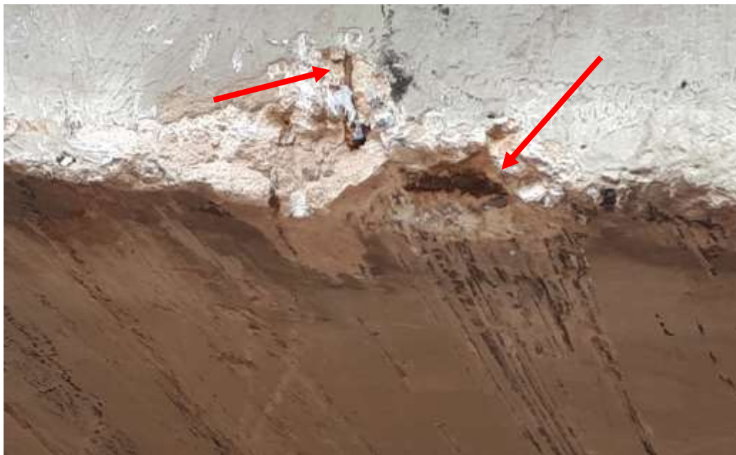
Figura 6 - Corrosão de armaduras na parte inferior do tabuleiro. Fonte: AUTORES (2018)
