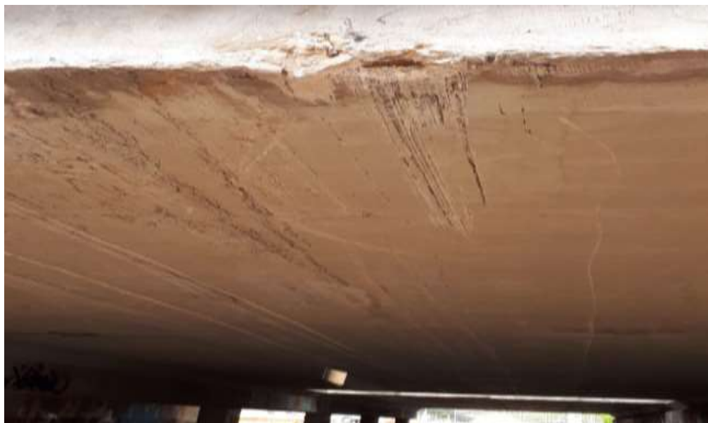
Figura 8 – Desgaste superficial e profundo na parte inferior do tabuleiro. Fonte: AUTORES (2018)
