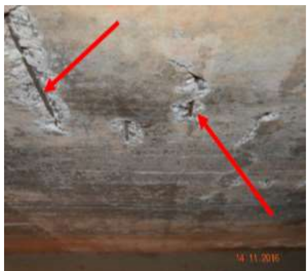
Figura 14 – Face inferior do tabuleiro em 2016. Fonte: OLIVEIRA et al (2016)
