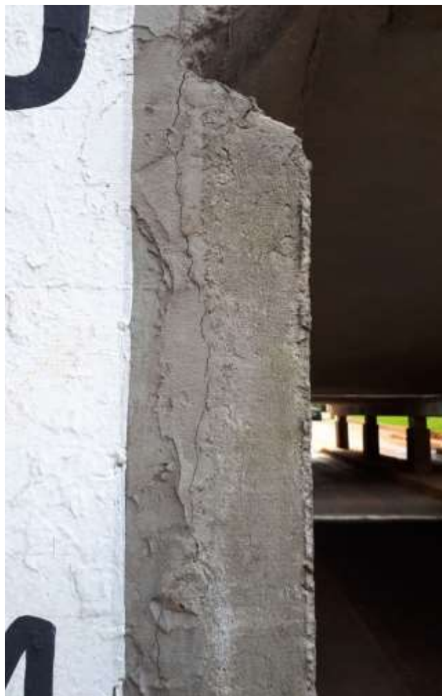
Figura 4 - Fissura na estrutura. Fonte: AUTORES (2018)
