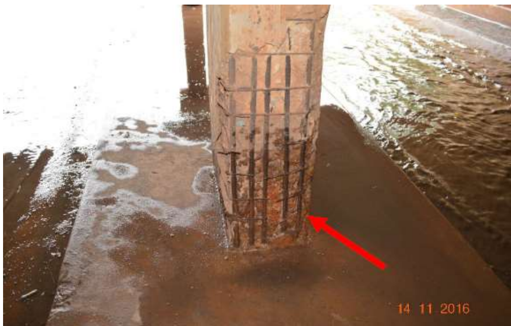
Figura 1 - Pilar central com deslocamento e armaduras expostas com alto grau de corrosão. Fonte: OLIVEIRA et al (2016)
