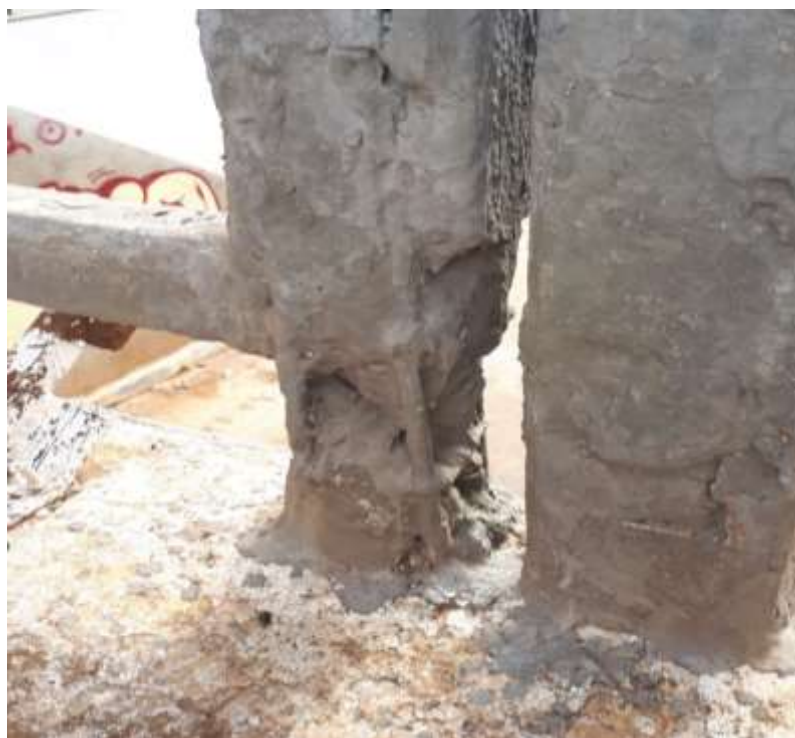
Figura 9 - Deterioração no guarda-corpo. Fonte: AUTORES (2018)
