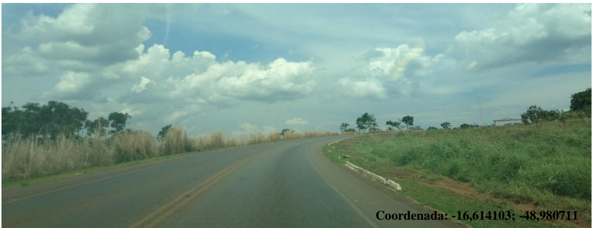
Figura 21. Área 6, curva horizontal aberta sem sinalização vertical, Bonfinópolis
