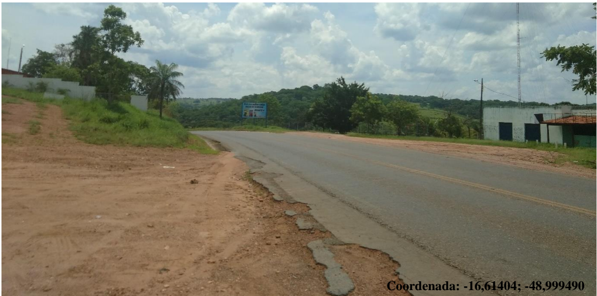
Figura 19. Área 5, curva horizontal aberta sem sinalização vertical na GO 010, Bonfinópolis
