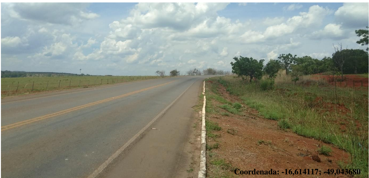
Figura 17. Área 4, curva horizontal sem sinalização vertical na GO 010, Bonfinópolis
