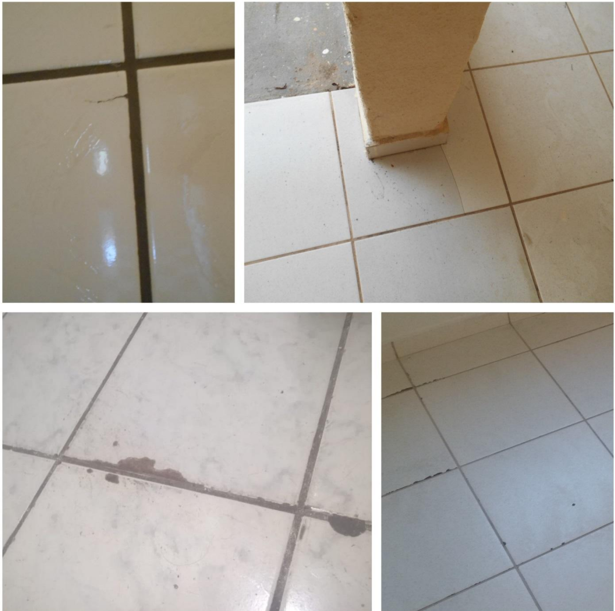
Figura 1.10: Trincas e lascamentos em peças cerâmicas encontradas em visitas in-loco aos imóveis.
