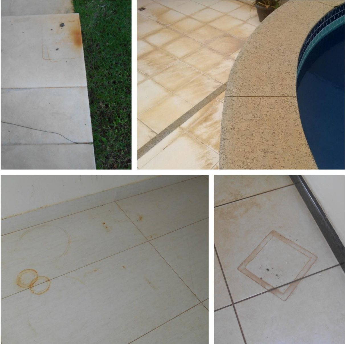
Figura 1.9: Manchas encontradas nas peças cerâmicas em visita in-loco.
