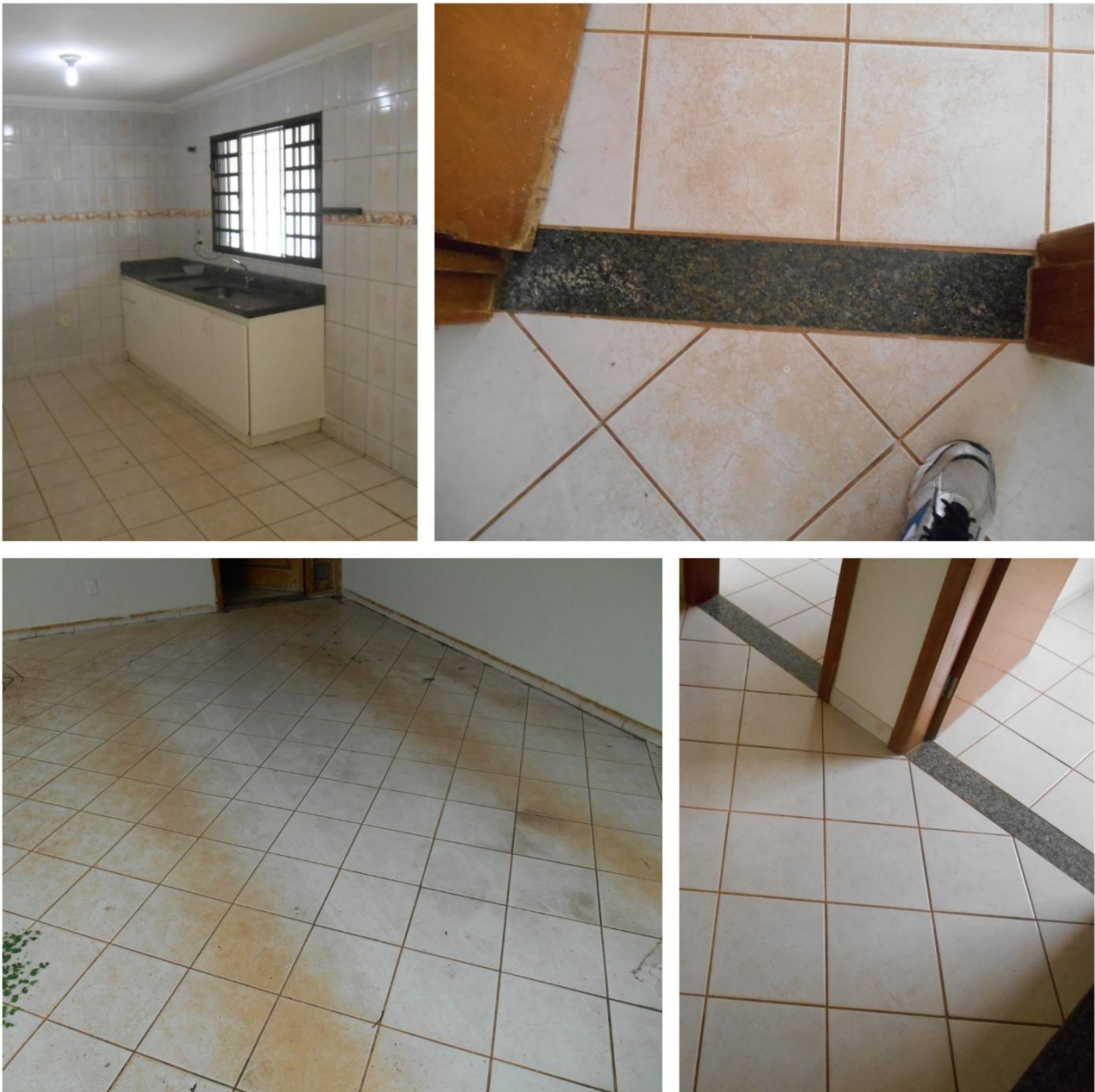
Figura 1.4: Fotografias dos pisos de um imóvel localizado no Jardim Atlântico com desgaste superficial por abrasão nas peças cerâmicas.
