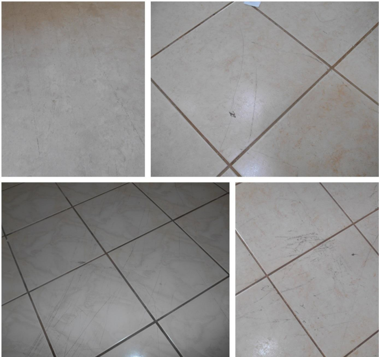
Figura 1.7: Fotografias analisadas in-loco dos pisos cerâmicos com patologias por riscos.
