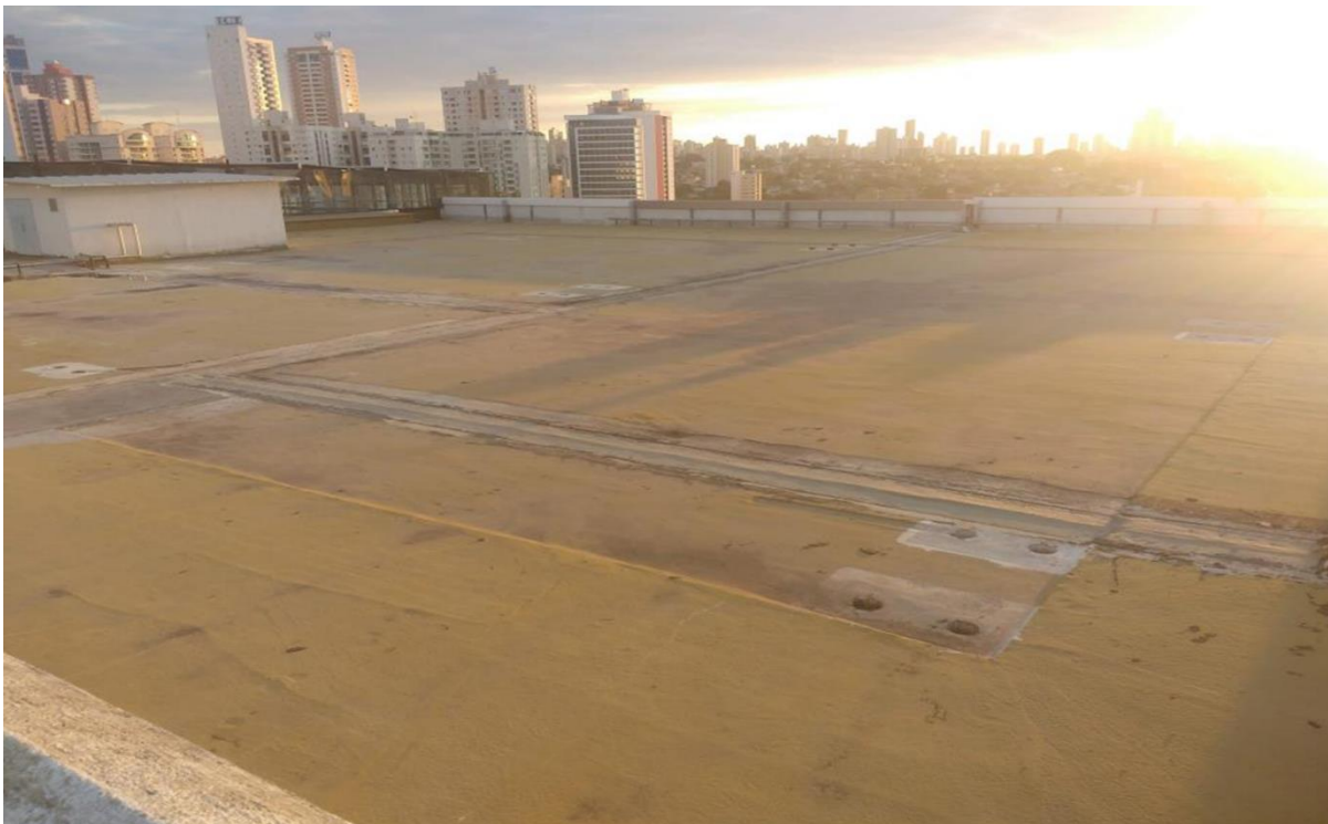
Figura 8. Laje do edifício A impermeabilizada com poliuréia, que apresentou patologias.
