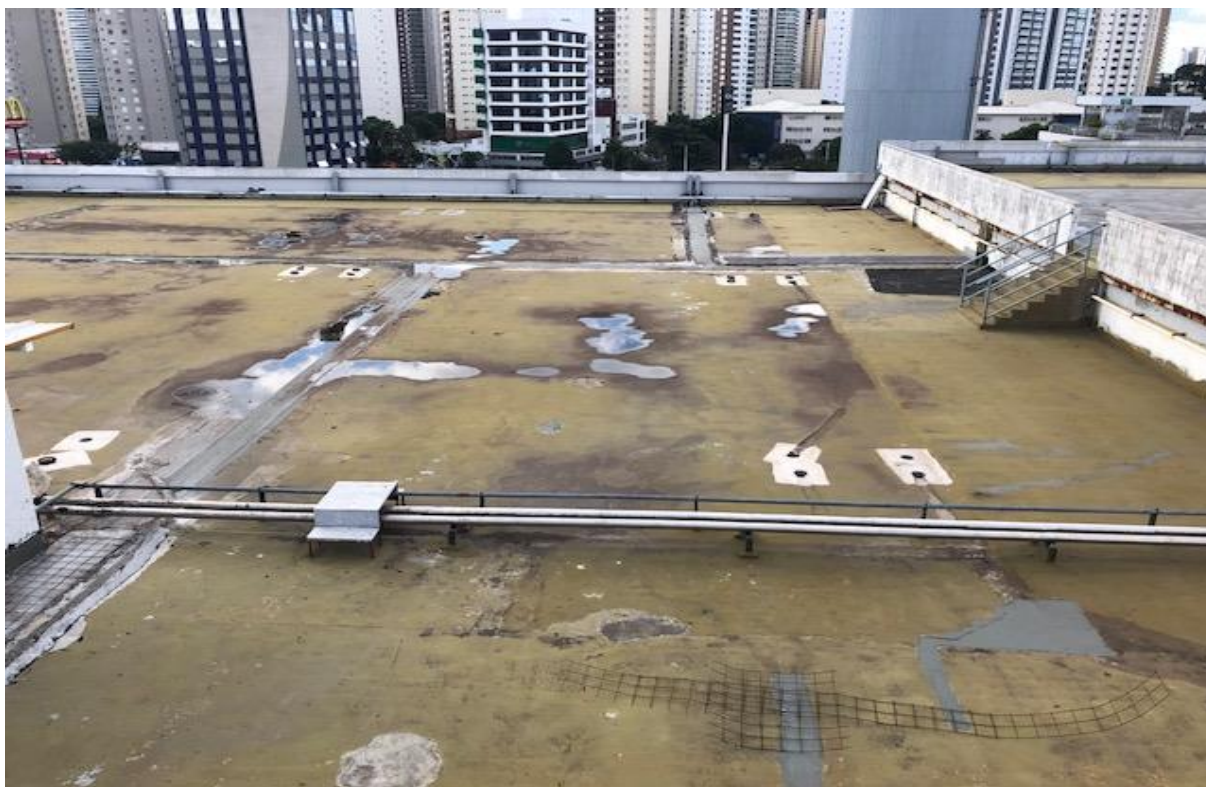
Figura 1. Vista superior da laje de cobertura com impermeabilização existente ineficiente do edifício A.
