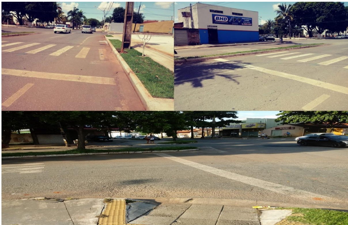
Figura 9: Problemas com as rampas de acesso.
