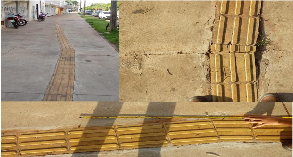
Figura 14: Falta de Piso de Alerta.
