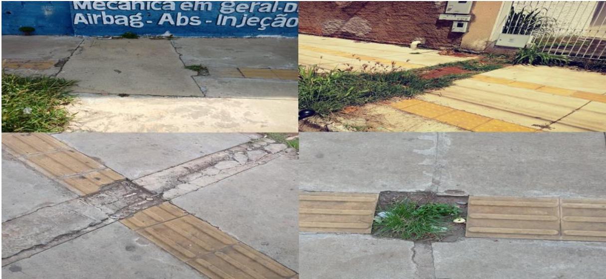
Figura 11: Falta de Manutenção no Piso Tátil.
