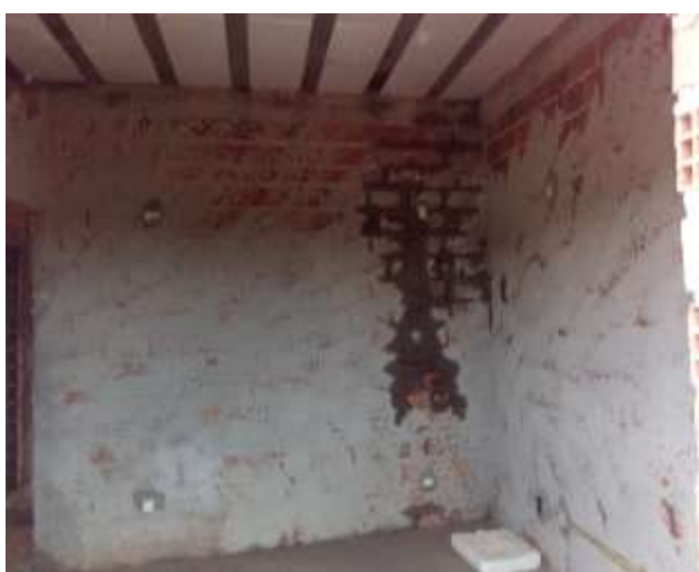
Figura 4. Taliscamento das paredes
