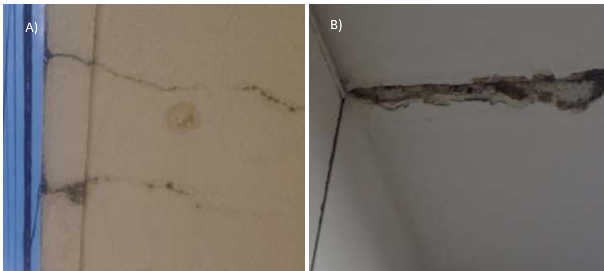
Figura 9: A. Marquises apresentam fissura; B. marquises apresentam trincas.
