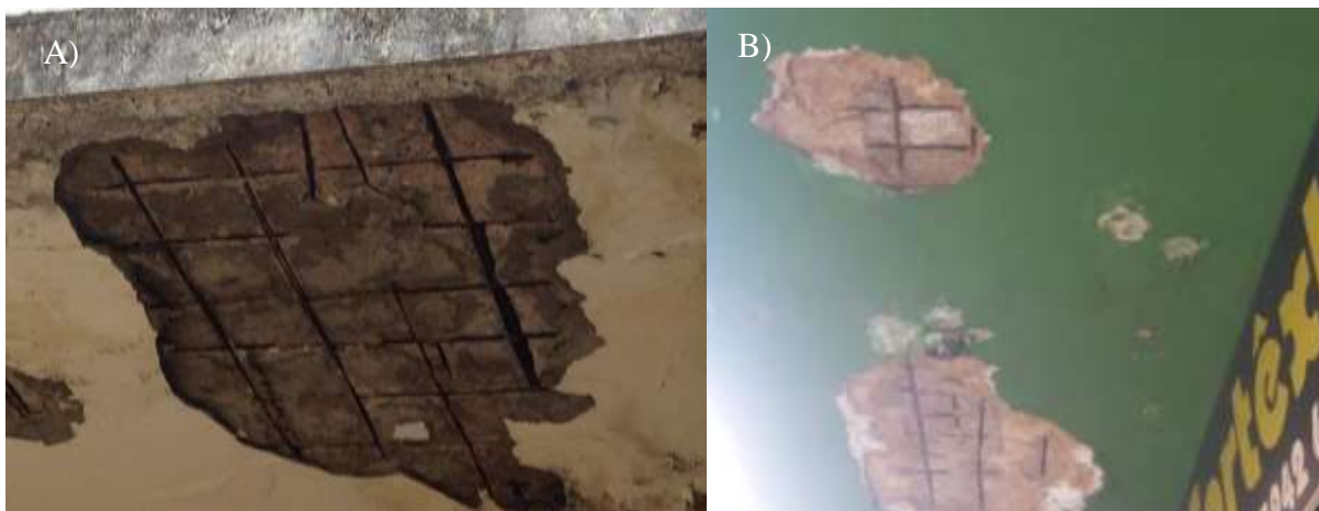
Figura 10: A. Marquises apresentam armadura exposta; B. Marquises que apresentam descolamento do revestimento argamassado.
