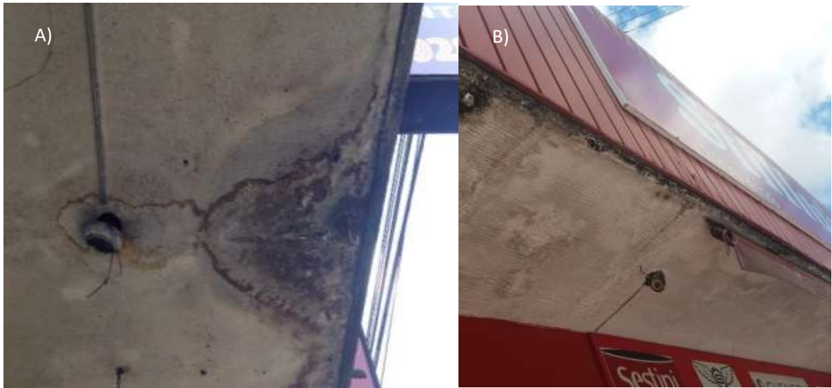
Figura 8: A. Marquises apresentam bolor; B. marquises apresentam manchas por umidade
