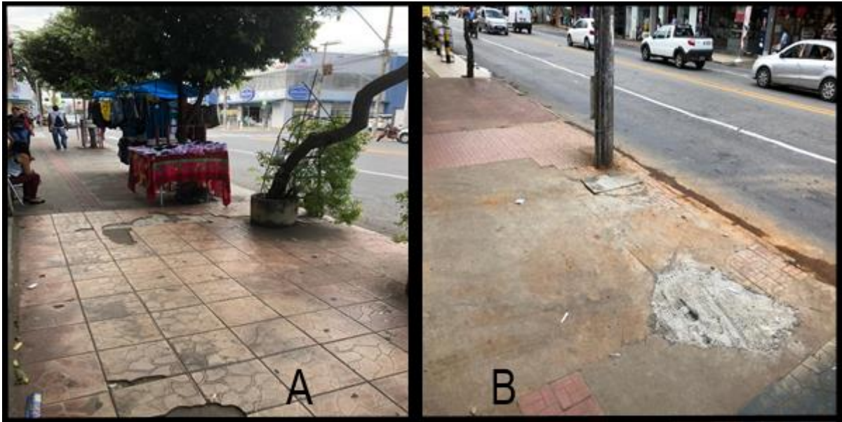
Figura 3: Calçadas em estado de conservação precário com ausência de pisos ( A ), presença de desníveis e rachaduras ( B ).
