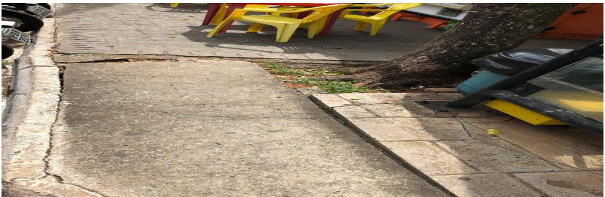
Figura 9: Rachaduras causadas pelas raízes das arvores
