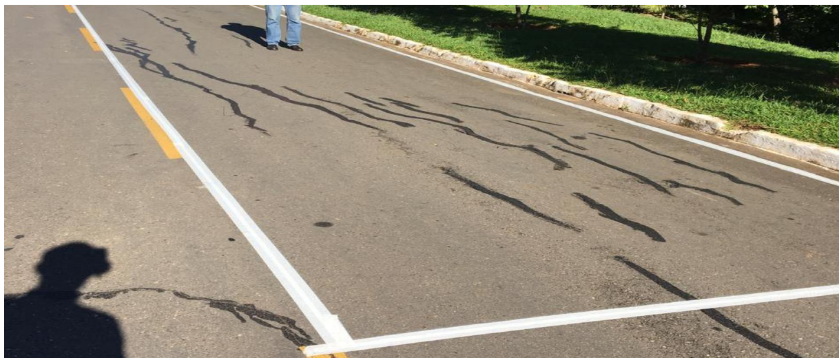
Figura 3. Pavimento asfáltico antes da aplicação do TL-2000.
