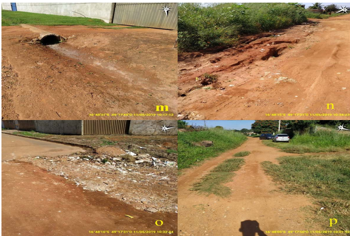
Figura 4. (m) - Sistema de Drenagem Improvisado, (n) - Erosão no Solo, (o) - Entulhos e (p) – Vegetação.
