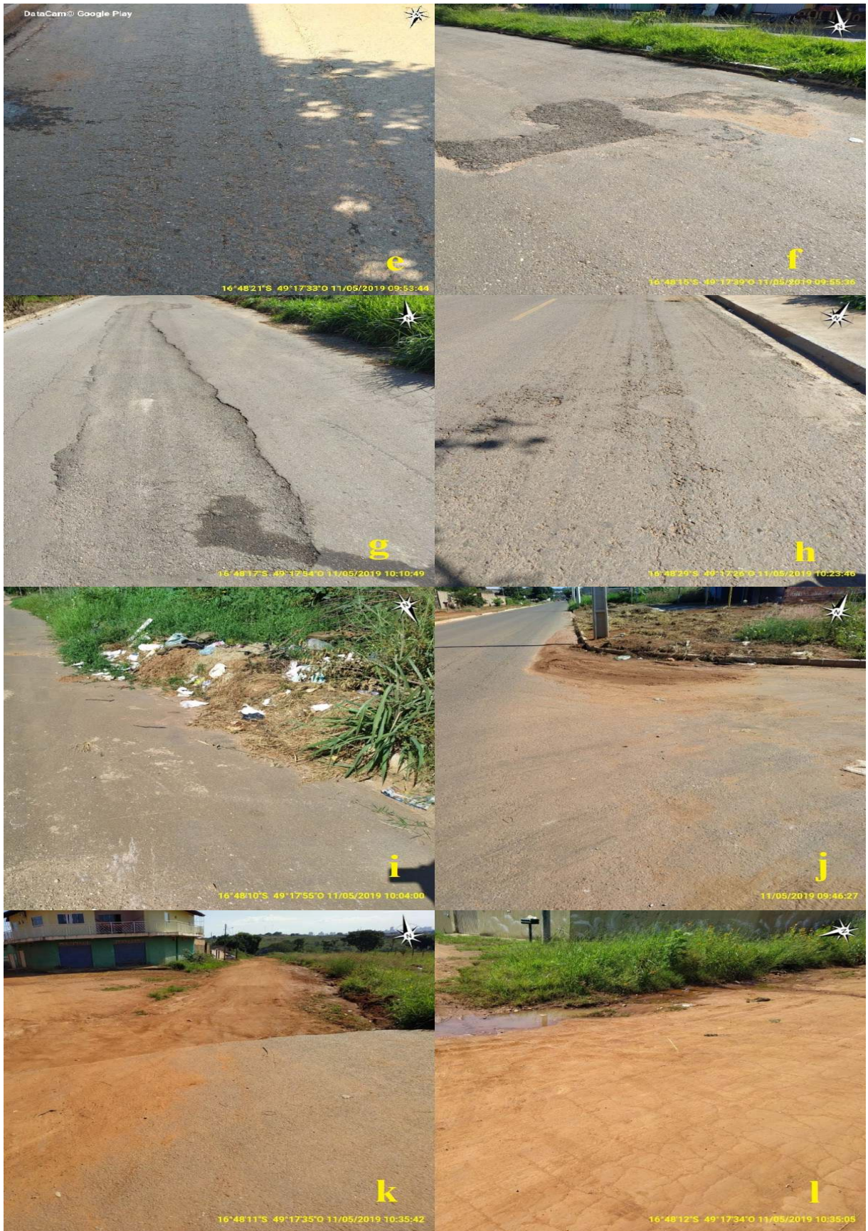
Figura 3. (e) - Trincas e Rachaduras, (f) - Remendos, (g) - Afundamento, (h) - Bico de Espagador, (i) - Acumulo de Lixo, (j) - Acumulo de Terra, (k) - Falta de Pavimentação, (l) - Acumulo de Água.
