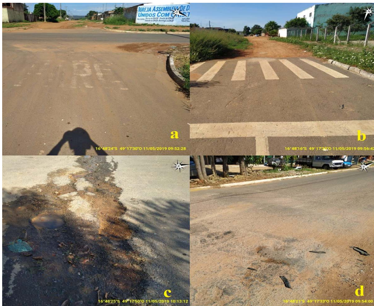
Figura 2. (a) - Falta de Sinalização, (b) - Falta de Duplicação, (c) - Buracos, (d) - Desgastes da massa asfáltica.
