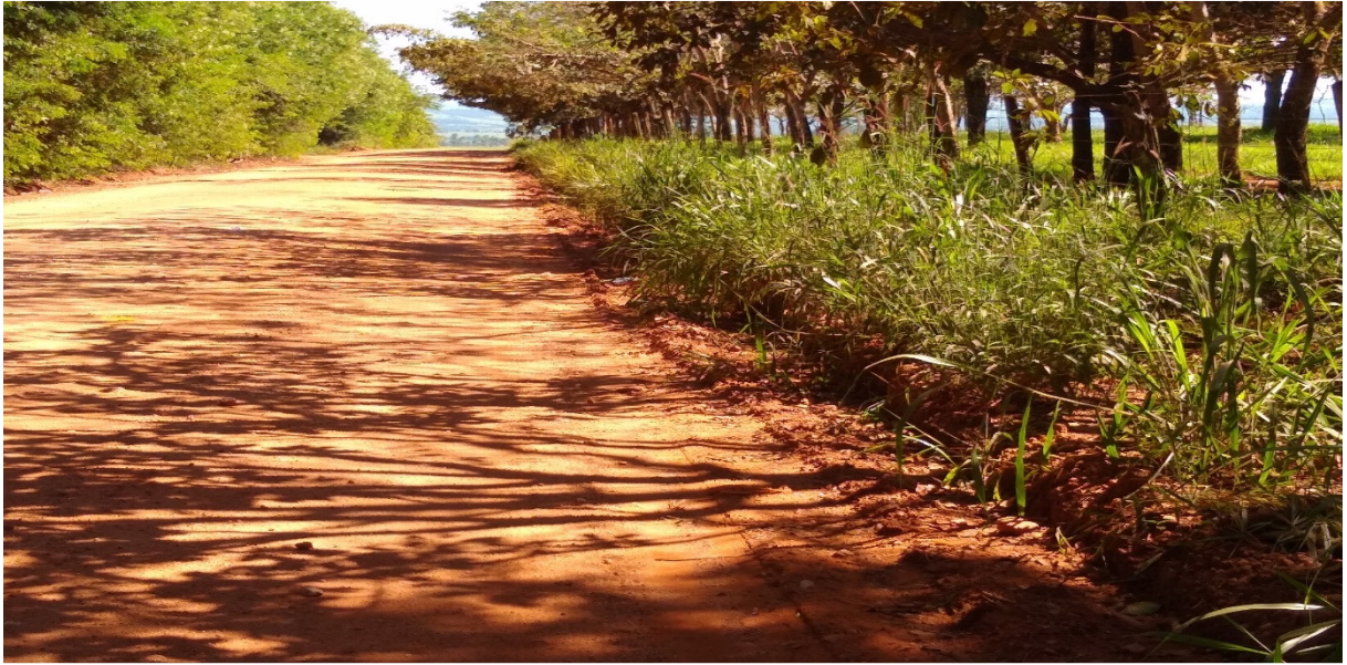
Figura 3. Valeta na estrada vicinal
