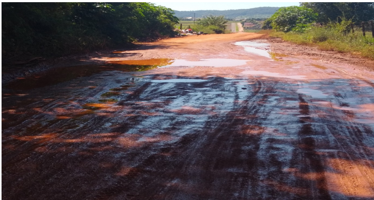
Figura 8. Seção transversal inadequada.
