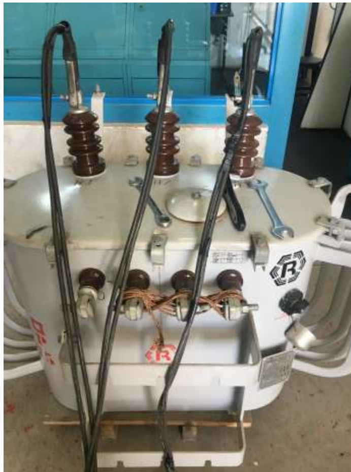
Figura 6. Ligações para ensaio de curto-circuito no transformador.
