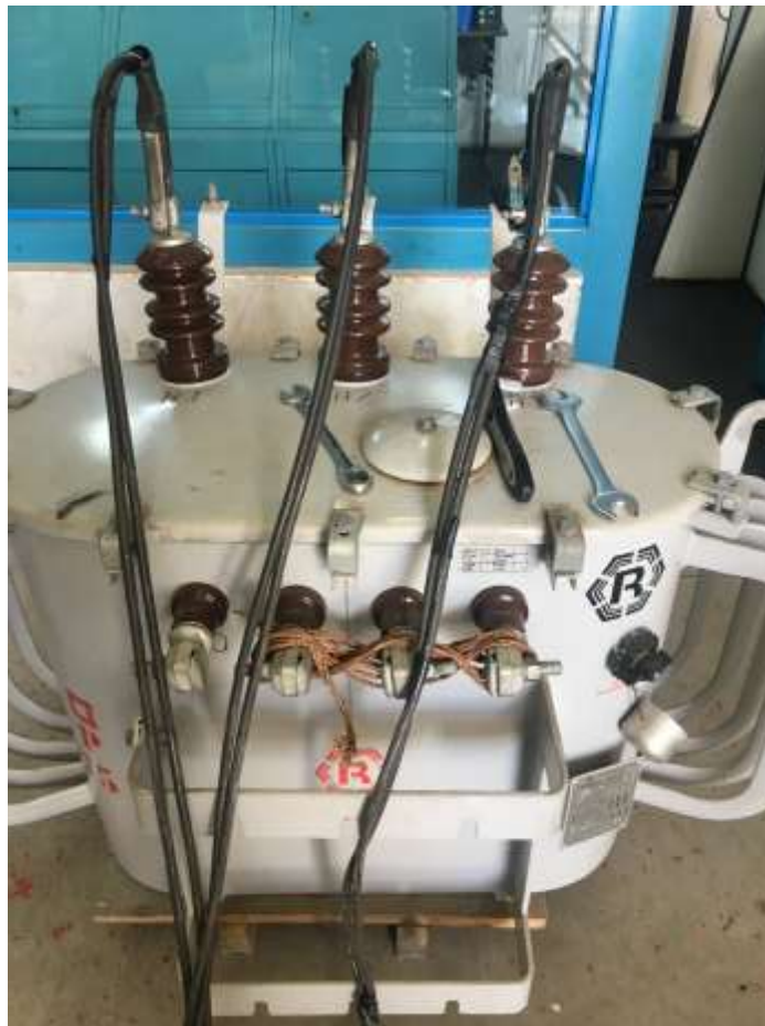
Figura 6. Ligações para ensaio de curto-circuito no transformador.
