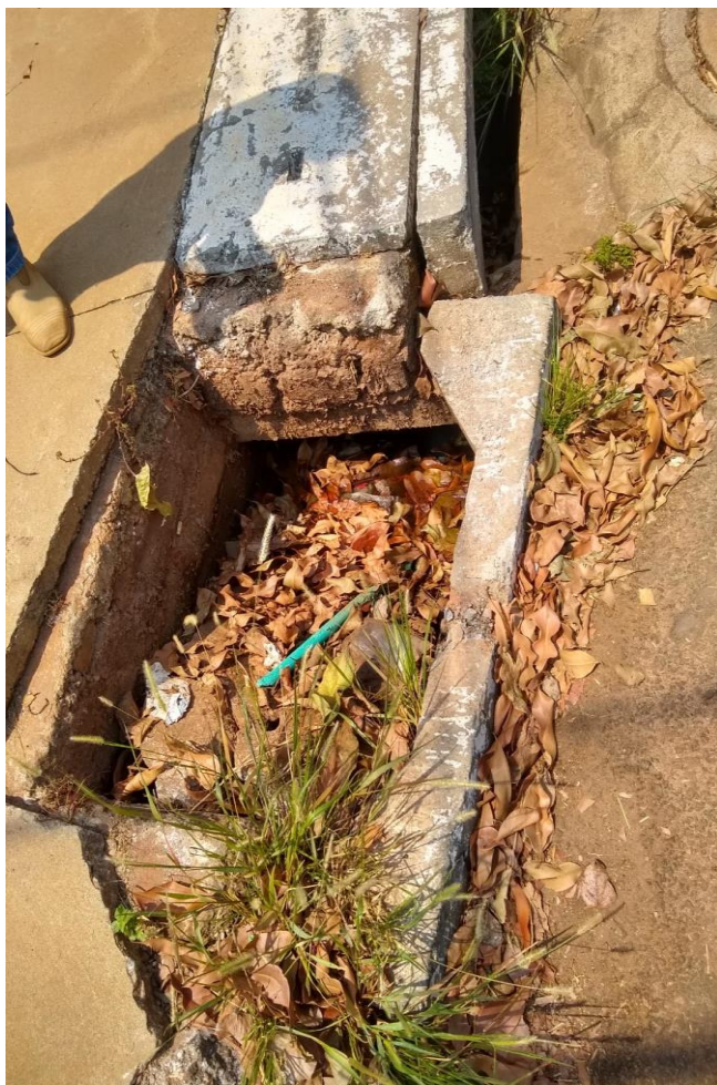
Figura 01. Boca de lobo obstruída na av. Guarapari.
