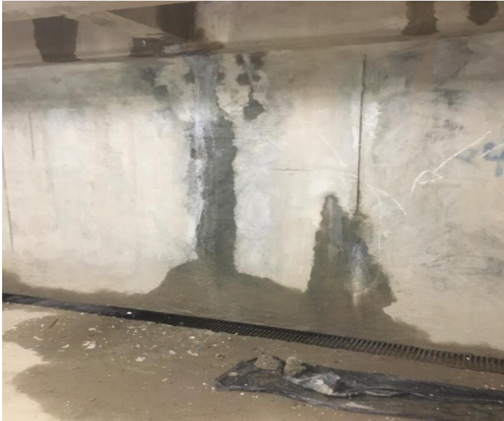
Figura 11 – Infiltração na cortina. Fonte: Grupo CF+ (2019).
