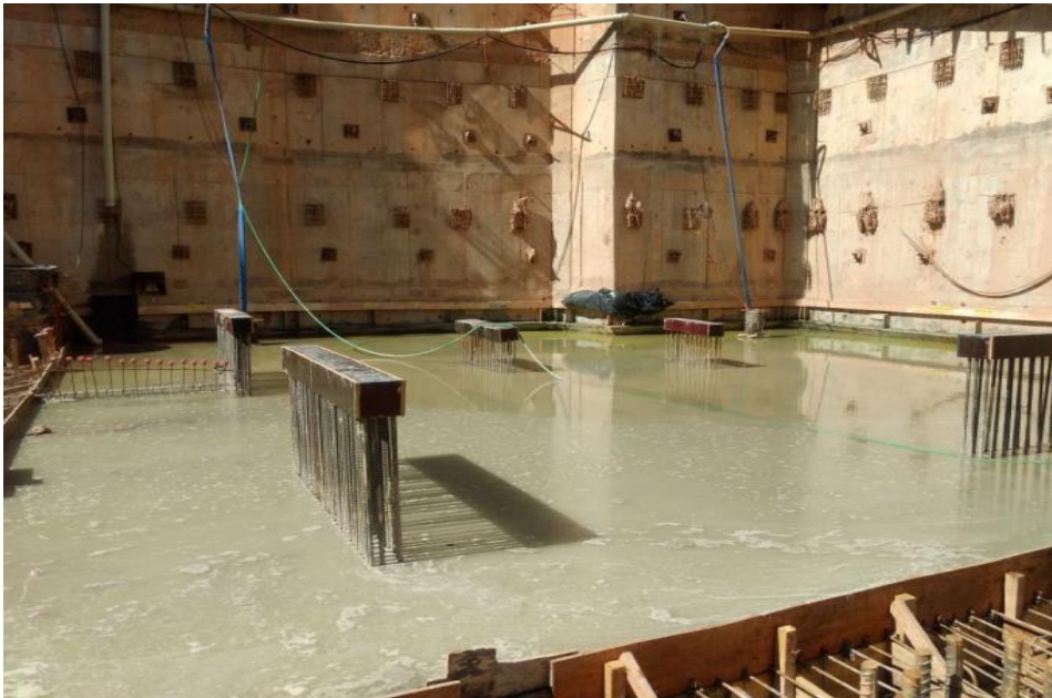
Figura 10 - Lâmina d'água sobre o concreto.
