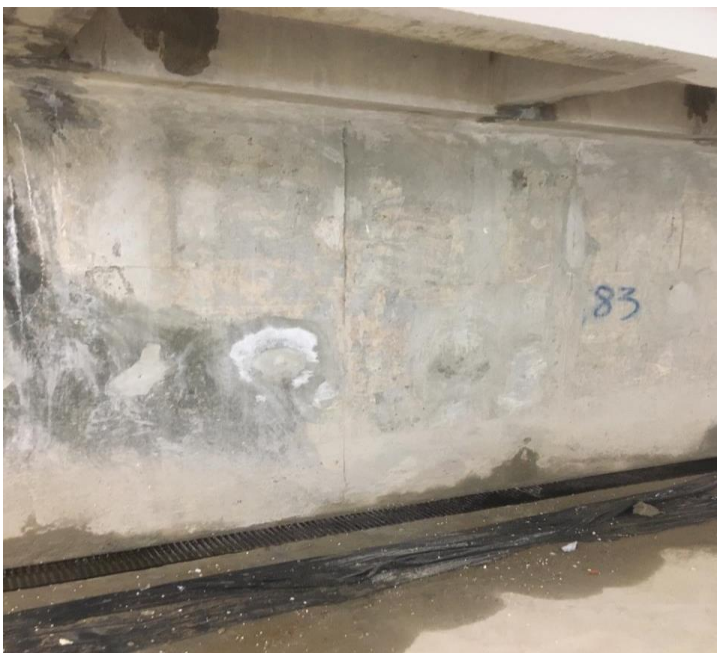
Figura 12 – Infiltração na laje. Fonte: Grupo CF+ (2019).
