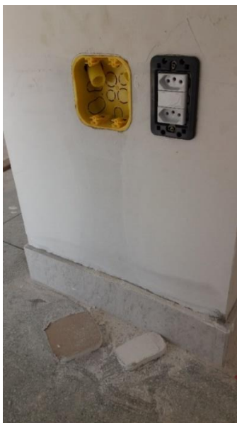
Figura 7: Resíduo gerado pela instalação elétrica nas parede de gesso acartonado.
