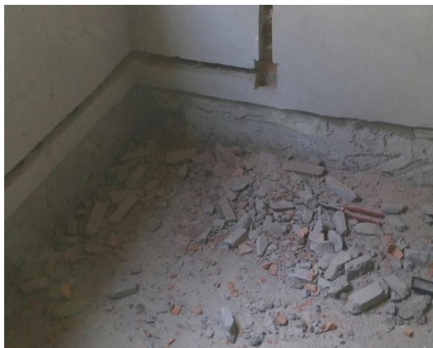
Figura 8: Resíduo gerado pela instalação elétrica nas paredes de tijolos cerâmicos.
