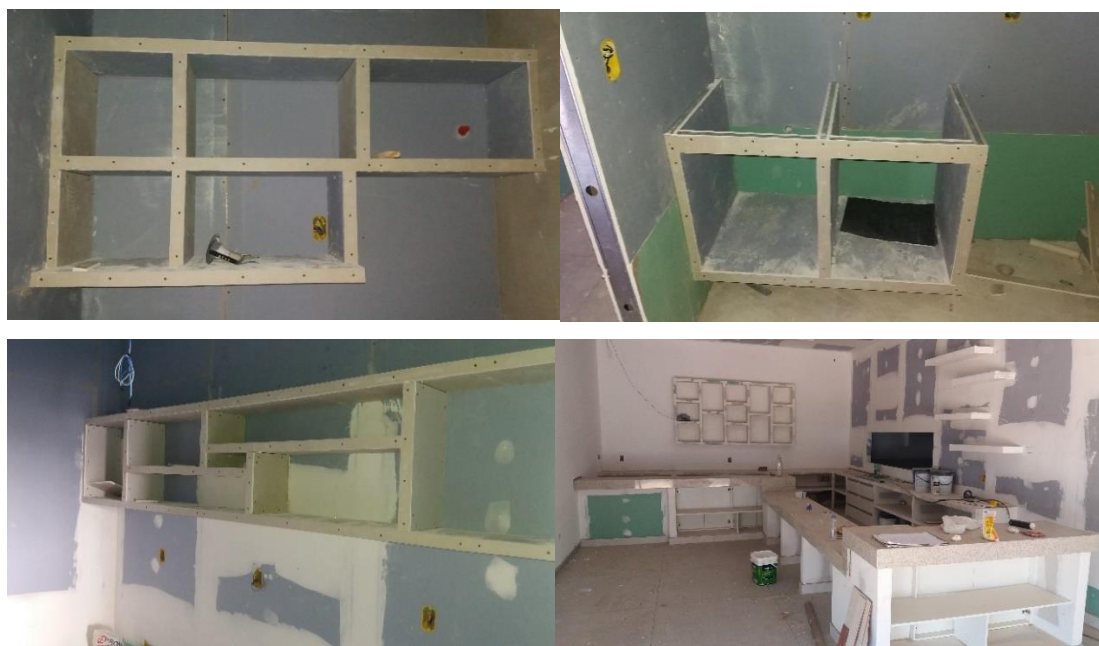
Figura 9: Armários, balcões e expositores feitos com gesso acartonado no showroom da Gessomat.
