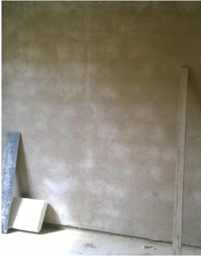
Figura 3: Parede externa dos lavabos.
