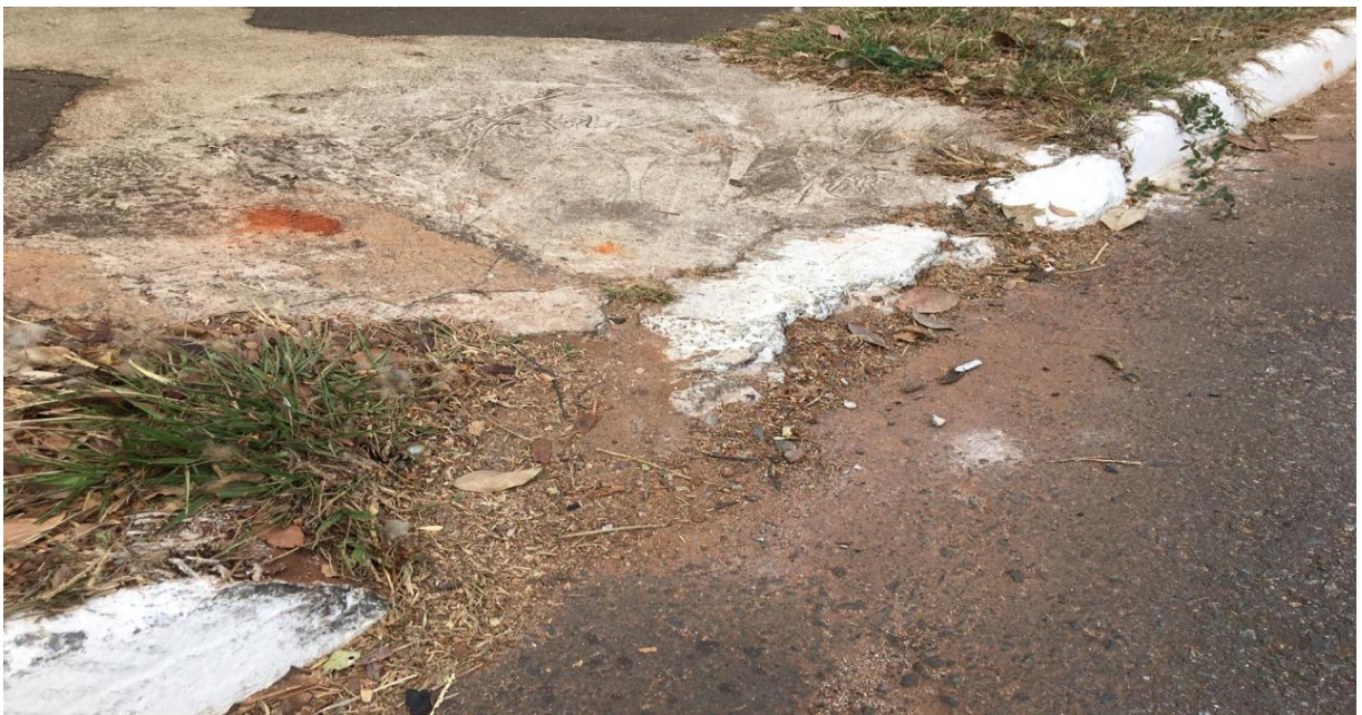
Figura 13: Falta de manutenção.
