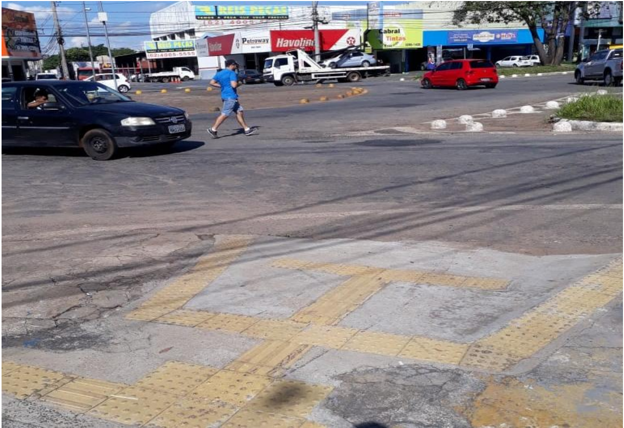
Figura 2. Rebaixo de calçada e flagrante de travessia indevida
