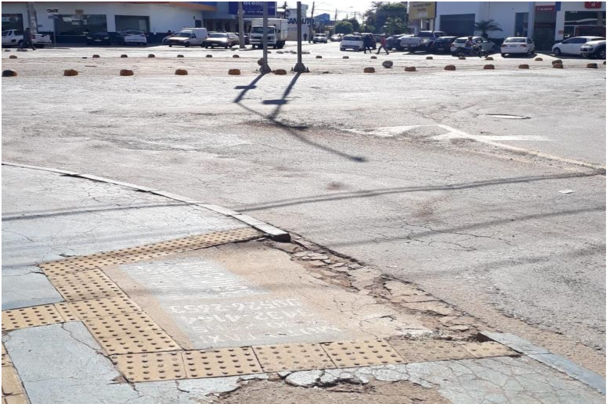
Figura 3. Rebaixo de calçada e passeio público utilizado como estacionamento
