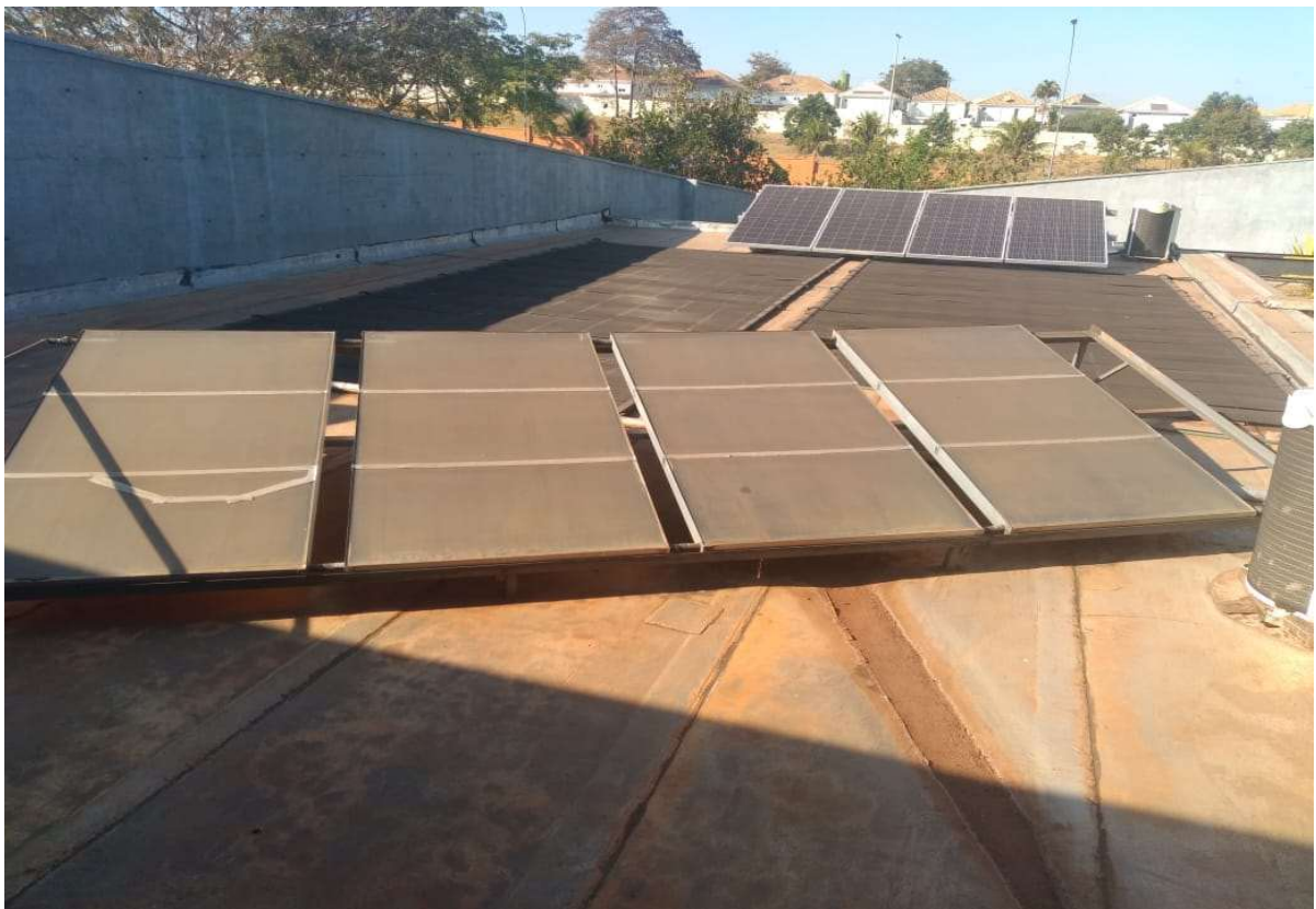
Figura 6: Sistema de Aquecimento Solar.
