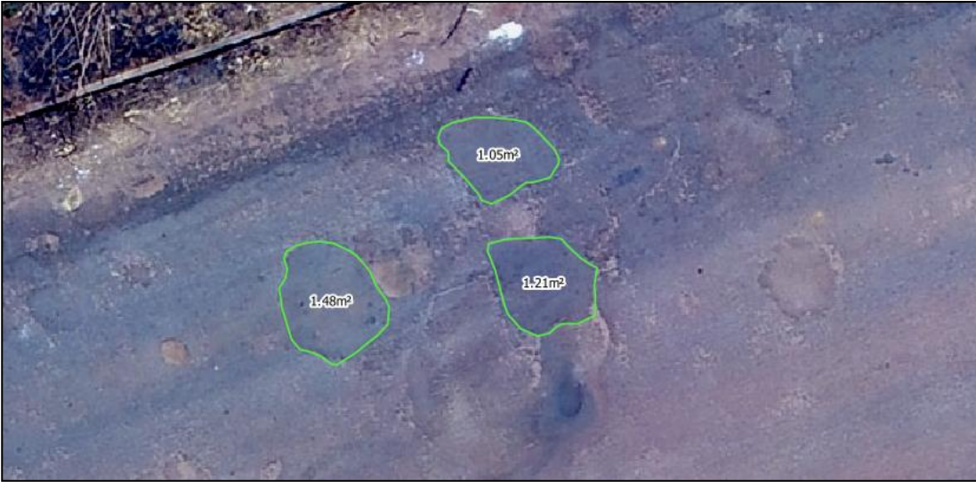
Figura 16. Patologia Remendo com a delimitação – Altura do drone: 60 metros.
