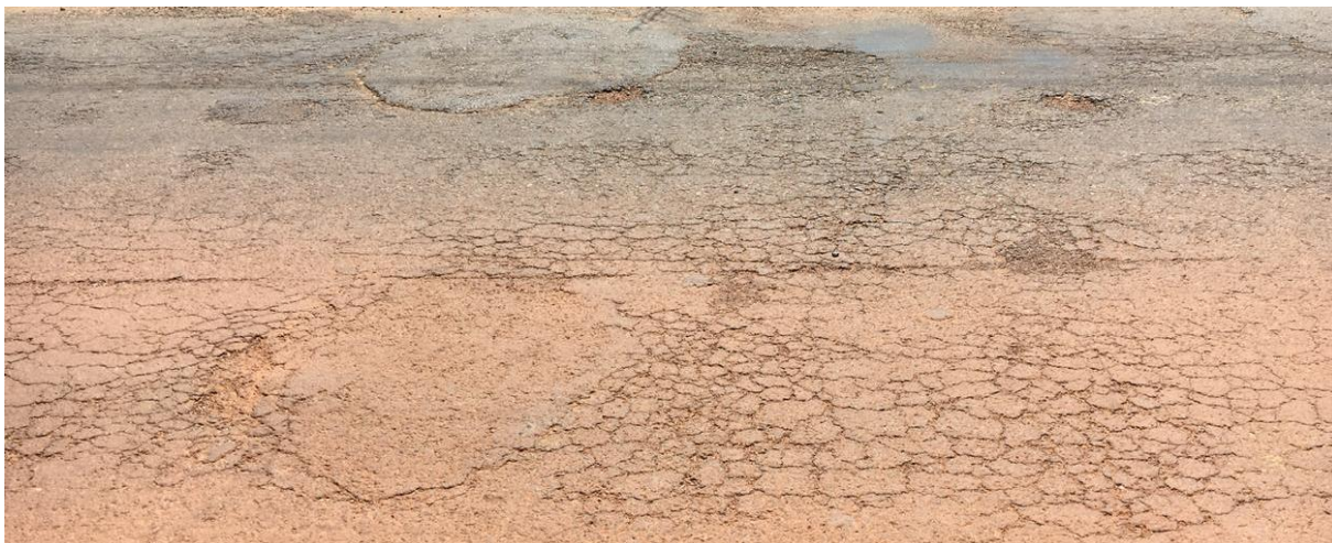
Figura 18. Patologia fissura e trinca.
