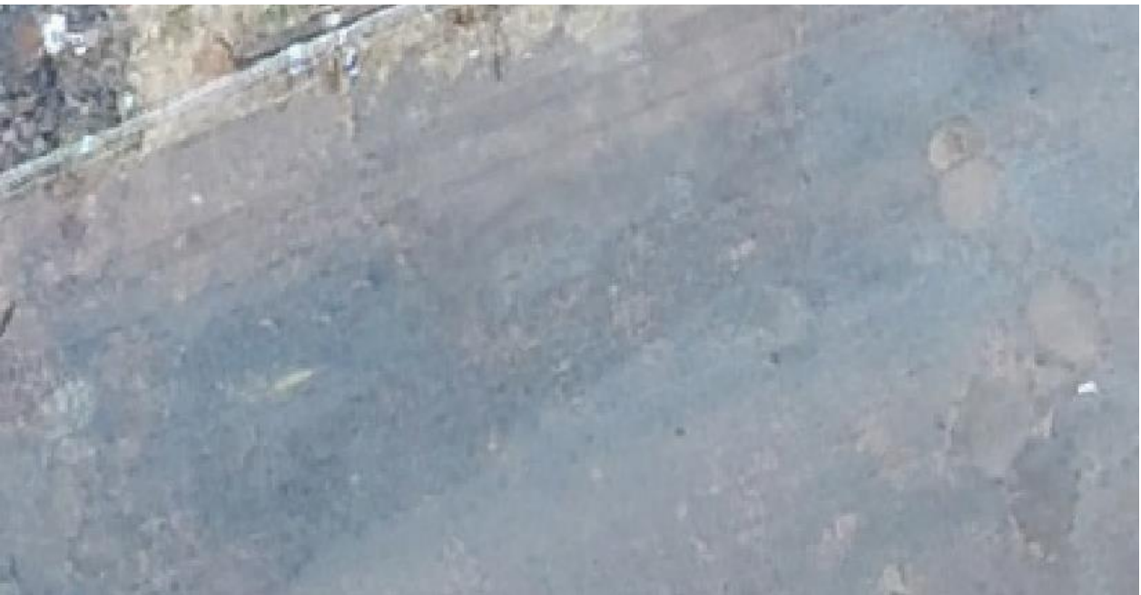
Figura 21. Patologia fissura e trinca na altura de 100 m.
