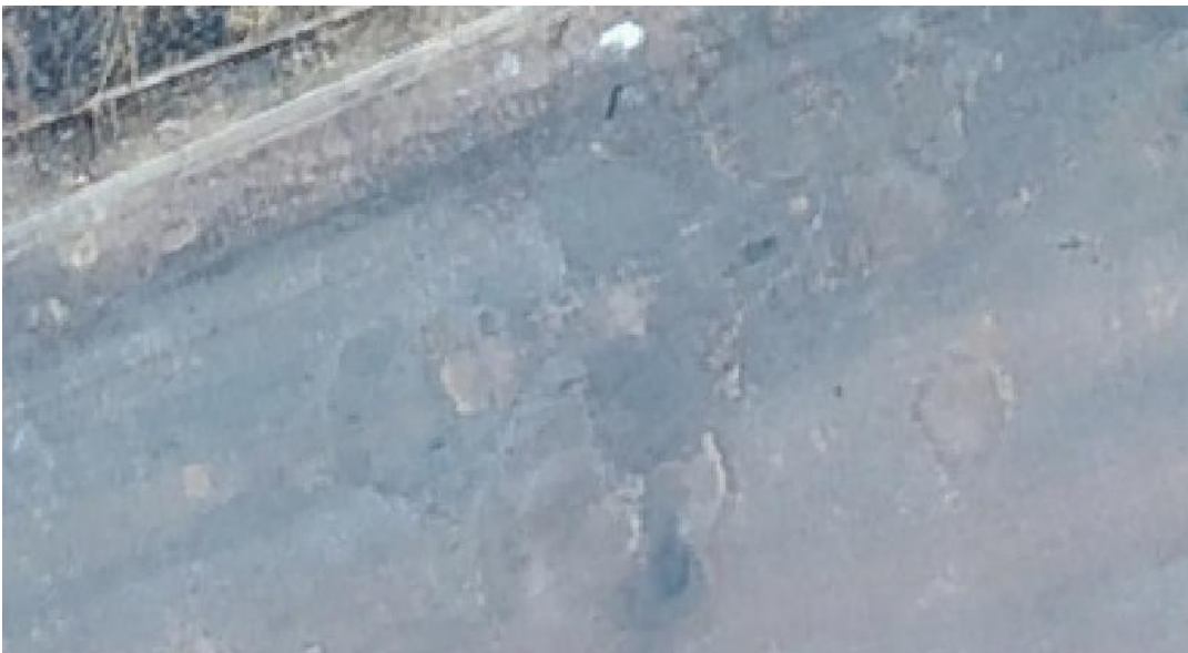
Figura 17. Patologia Remendo – Altura do drone: 100 metros.
