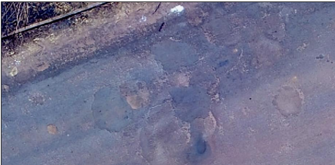
Figura 15. Patologia Remendo – Altura do drone: 60 metros.
