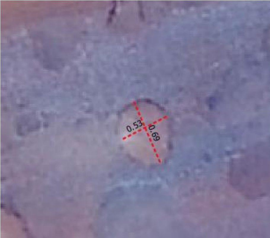
Figura 12. Identificação da patologia Buraco Pelo drone alturas 60 metros.
