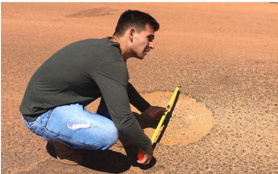
Figura 5. Patologia Buraco. (Lat: 16°55'1"S; Long: 49°27'25"O)
