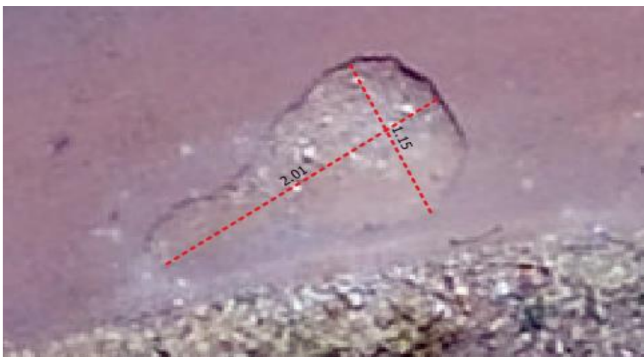
Figura 9. Identificação da patologia buraco, 60 metros.
