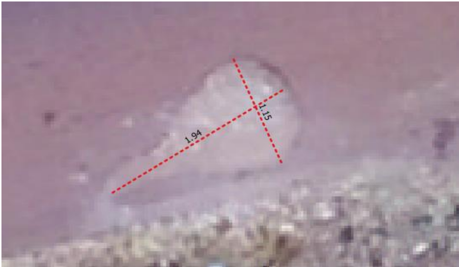
Figura 10. Identificação da patologia buraco, altura 100 metros.
