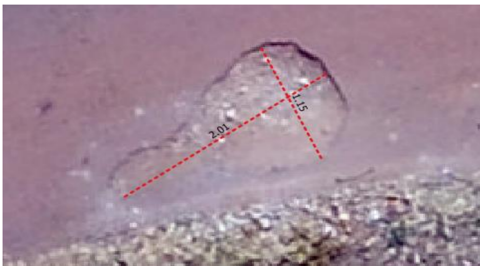
Figura 9. Identificação da patologia buraco, 60 metros.
