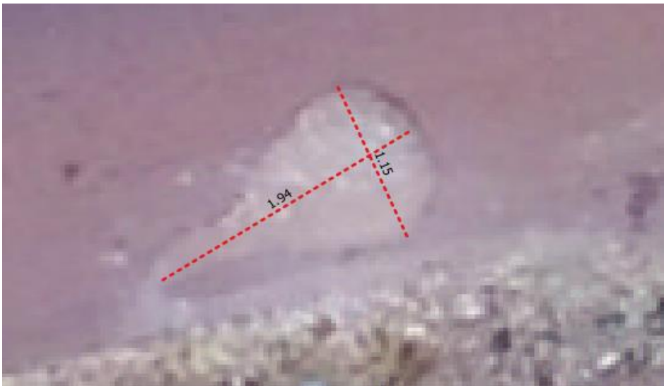
Figura 10. Identificação da patologia buraco, altura 100 metros.
