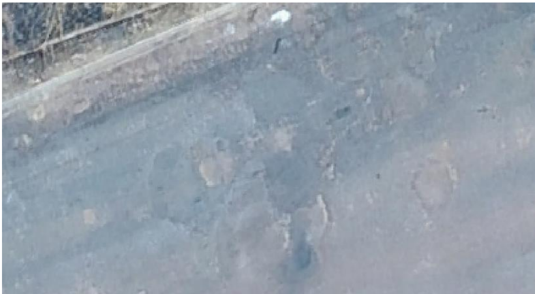
Figura 17. Patologia Remendo – Altura do drone: 100 metros.
