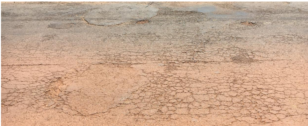
Figura 18. Patologia fissura e trinca.
