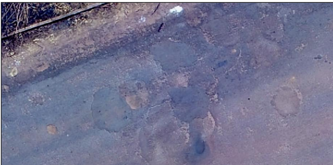
Figura 15. Patologia Remendo – Altura do drone: 60 metros.
