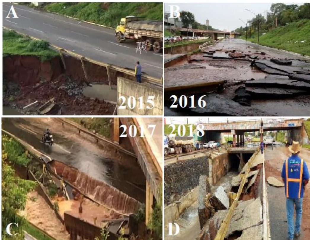
Figura 12: Problemas na Marginal Botafogo provocados pelas chuvas nos últimos 4 anos. Fonte: A: TV Anhanguera (2015), B: TV Anhanguera(2016), C: Matheus Monteiro (2017), D: Diomício Gomes(2018).
