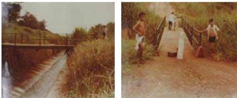
Figura 4 e 5: Fotos da ponte metálica sobre a canalização do córrego Botafogo (2019) Fonte: Centro de Documentação e Biblioteca da SEPLAN (2019)
