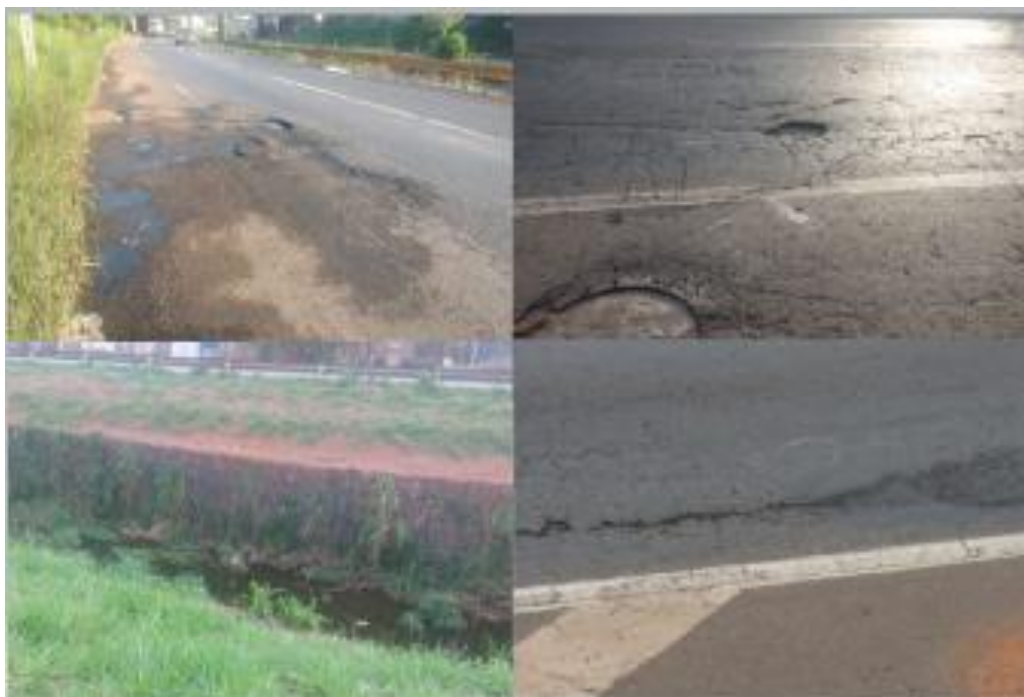
Figura 13: Patologias a Marginal Botafogo. Fonte: O autor (2019)
