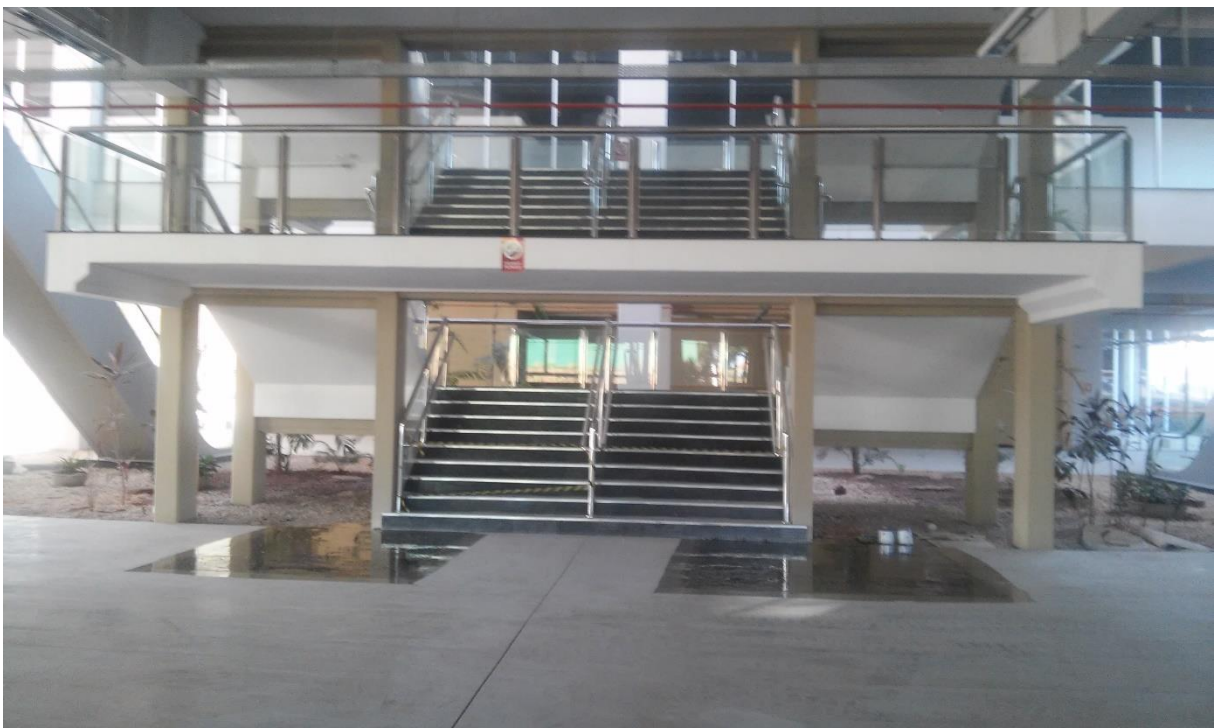
Figura 08. Escada do átrio com alterações. Fonte: Eduardo Mariano (2016).
