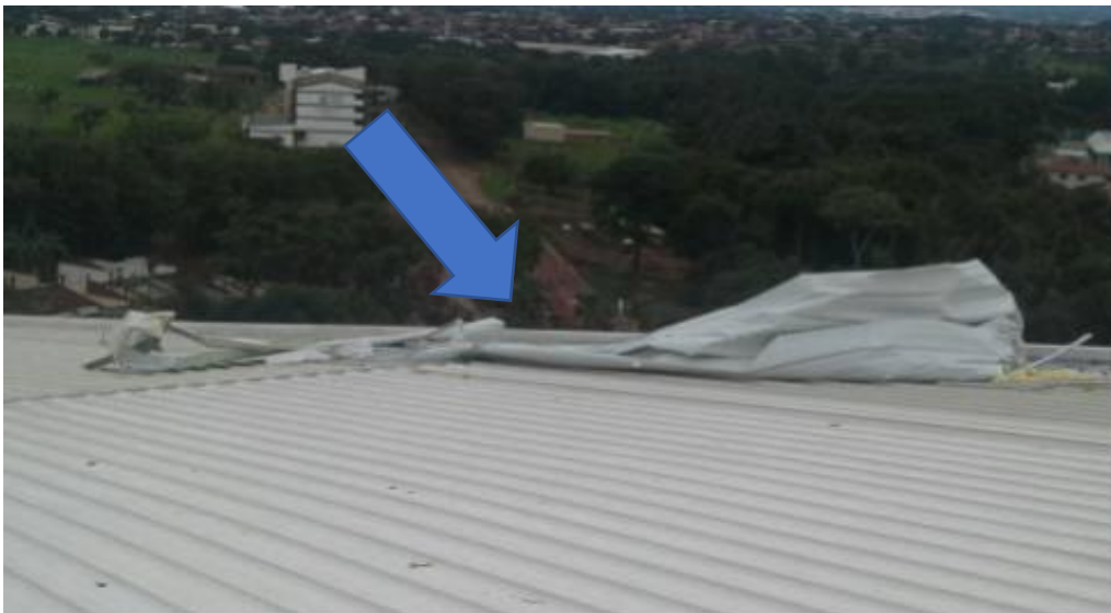
Figura 18. Telha danificada pelo vento. Fonte: Eduardo Mariano (2016)
