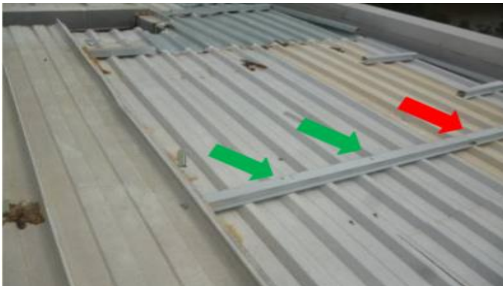
Figura 19. Sistema de fixação da telha (seta verde há fixação), (seta vermelha ausência de fixação).
