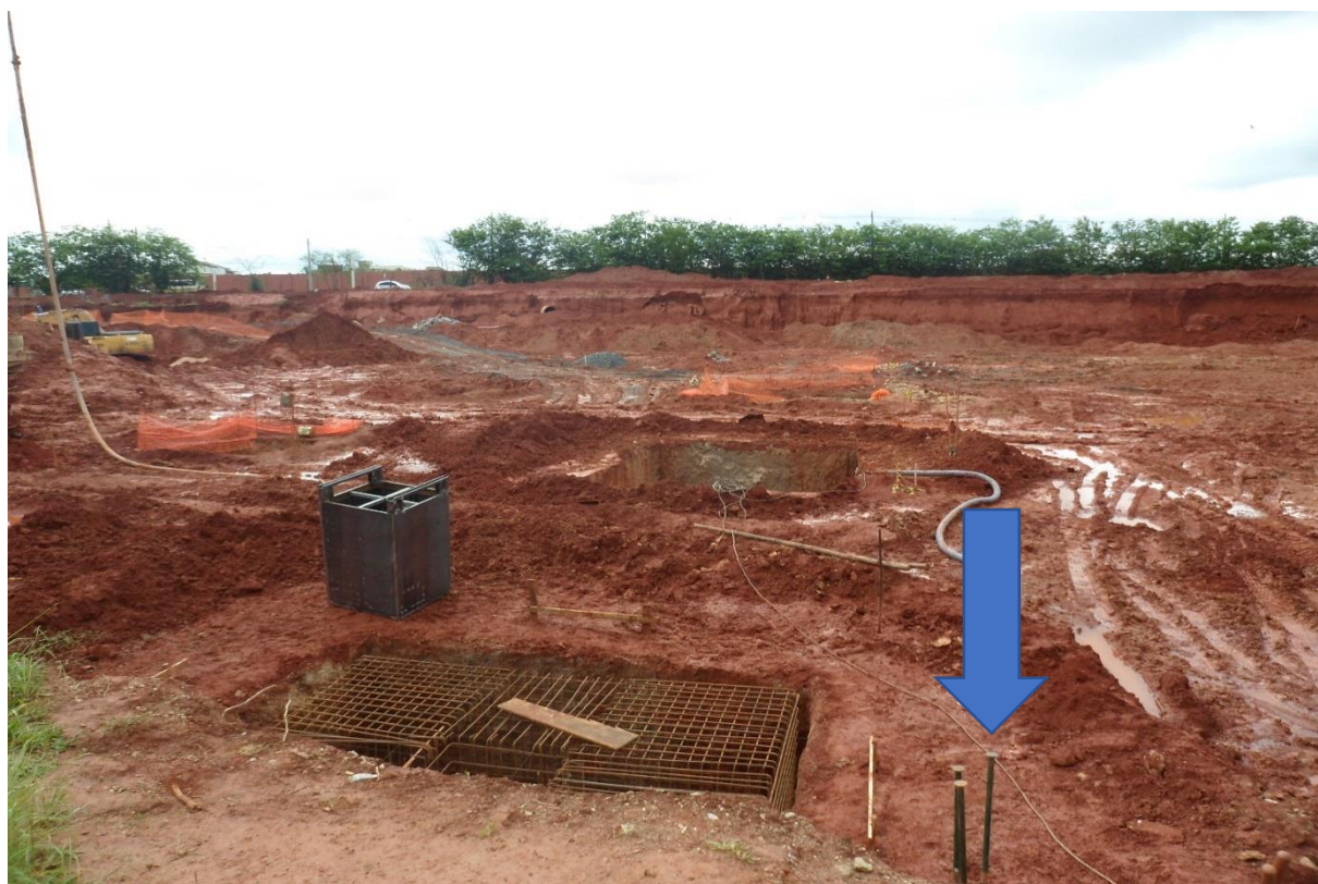
Figura 3. Estacas perdidas por mudança de locação. Fonte: Eduardo Mariano Cavalcante de Castro (2012)
