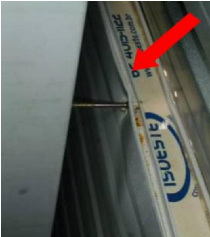
Figura 13. Falha de execução na fixação do painel. Fonte: Eduardo Mariano Cavalcante de Castro (2016).
