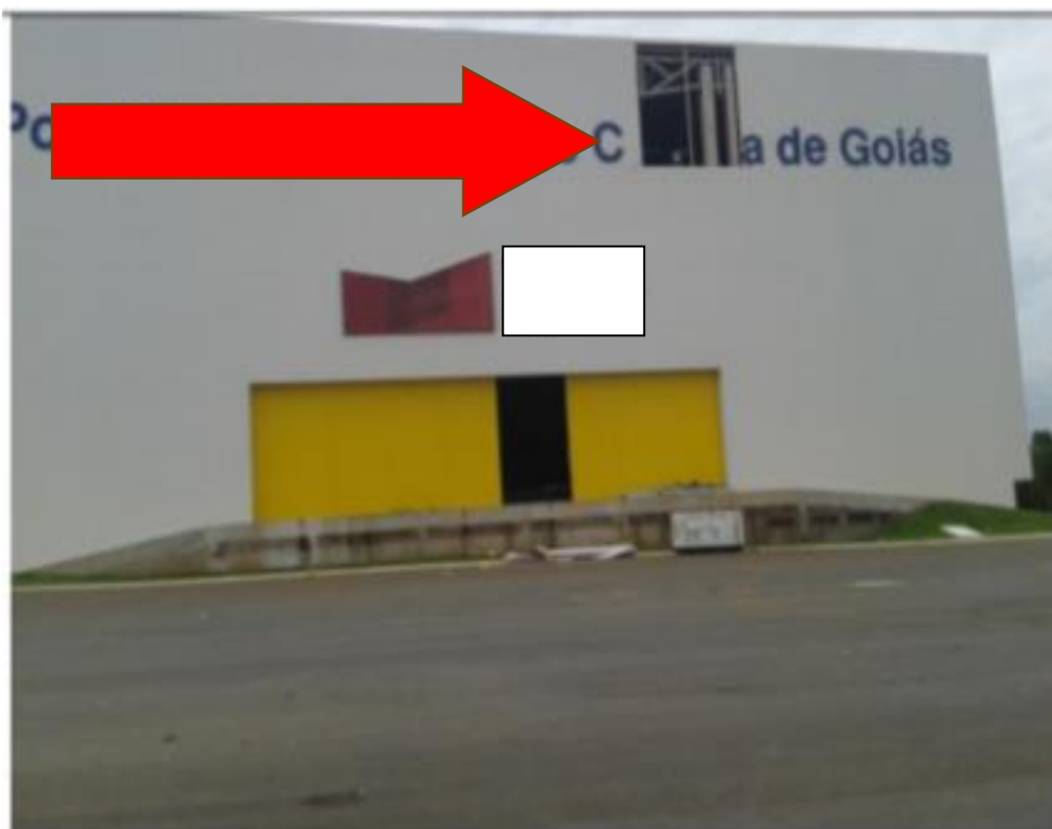
Figura 11. Painel arrancado pelo vento (nome da instituição coberto intencionalmente). Fonte: Eduardo Mariano Cavalcante de Castro (2016)
