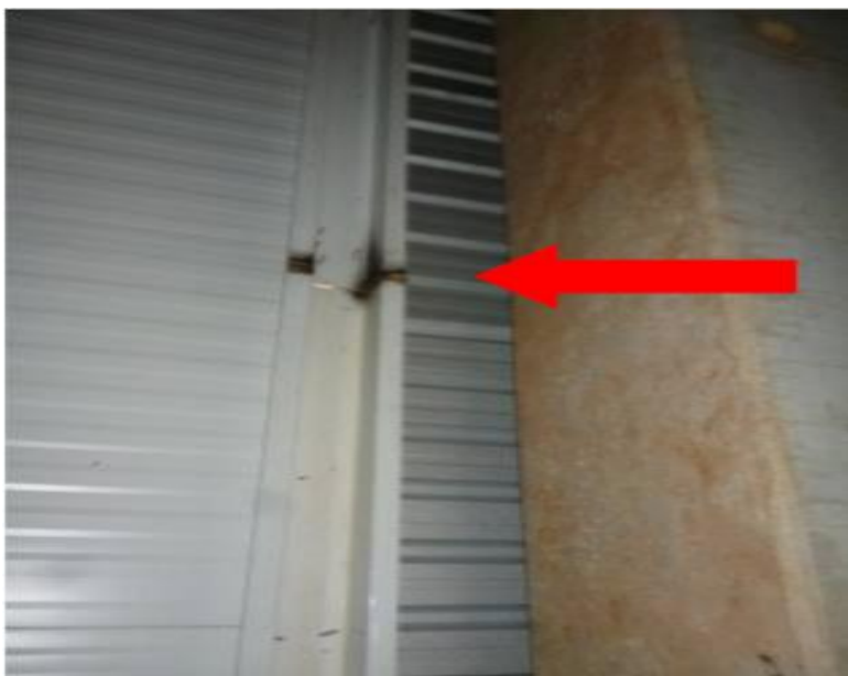
Figura 12. Perfil com falha na solda.
