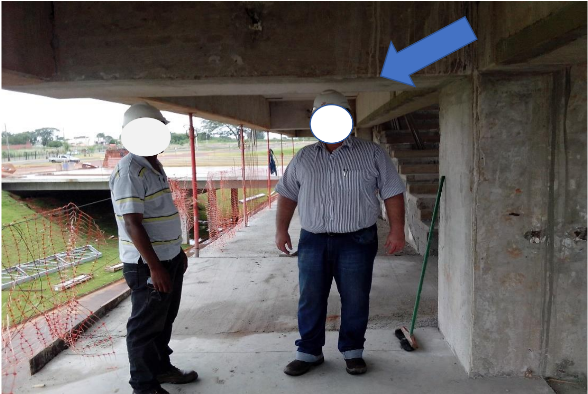
Figura 4. Pé direito com altura abaixo do estabelecido pela norma. Fonte: Eduardo Mariano Cavalcante de Castro (2013).
