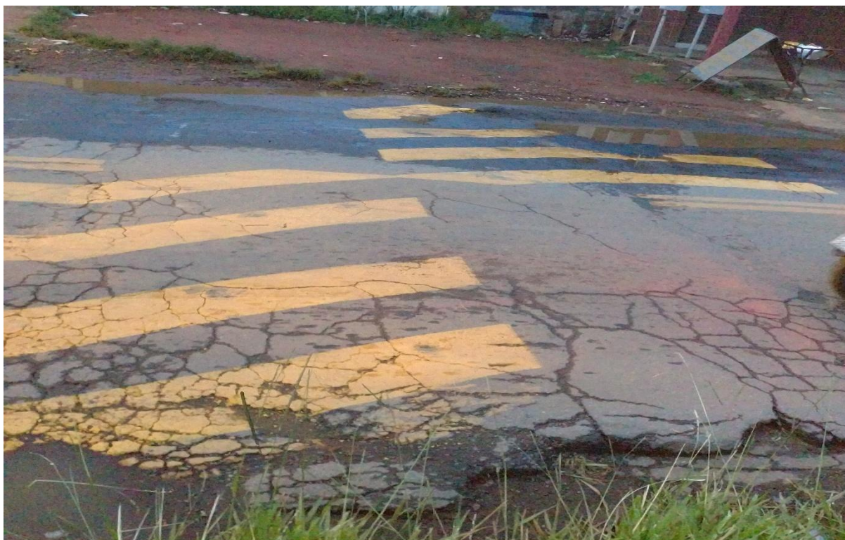
Figura 02: Falta de sinalização vertical para lombadas. Fonte: Google Earth (2019). Adaptado no Paint e AutoCAD pelo Autor.
