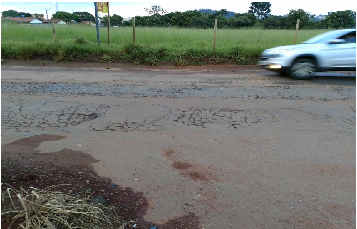
Figura 14: Patologias no pavimento.
