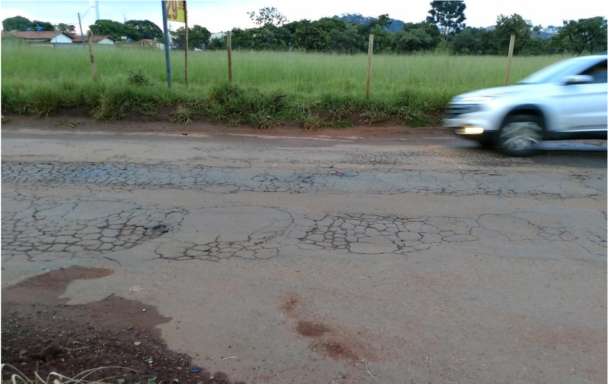
Figura 05: Patologias no pavimento.
