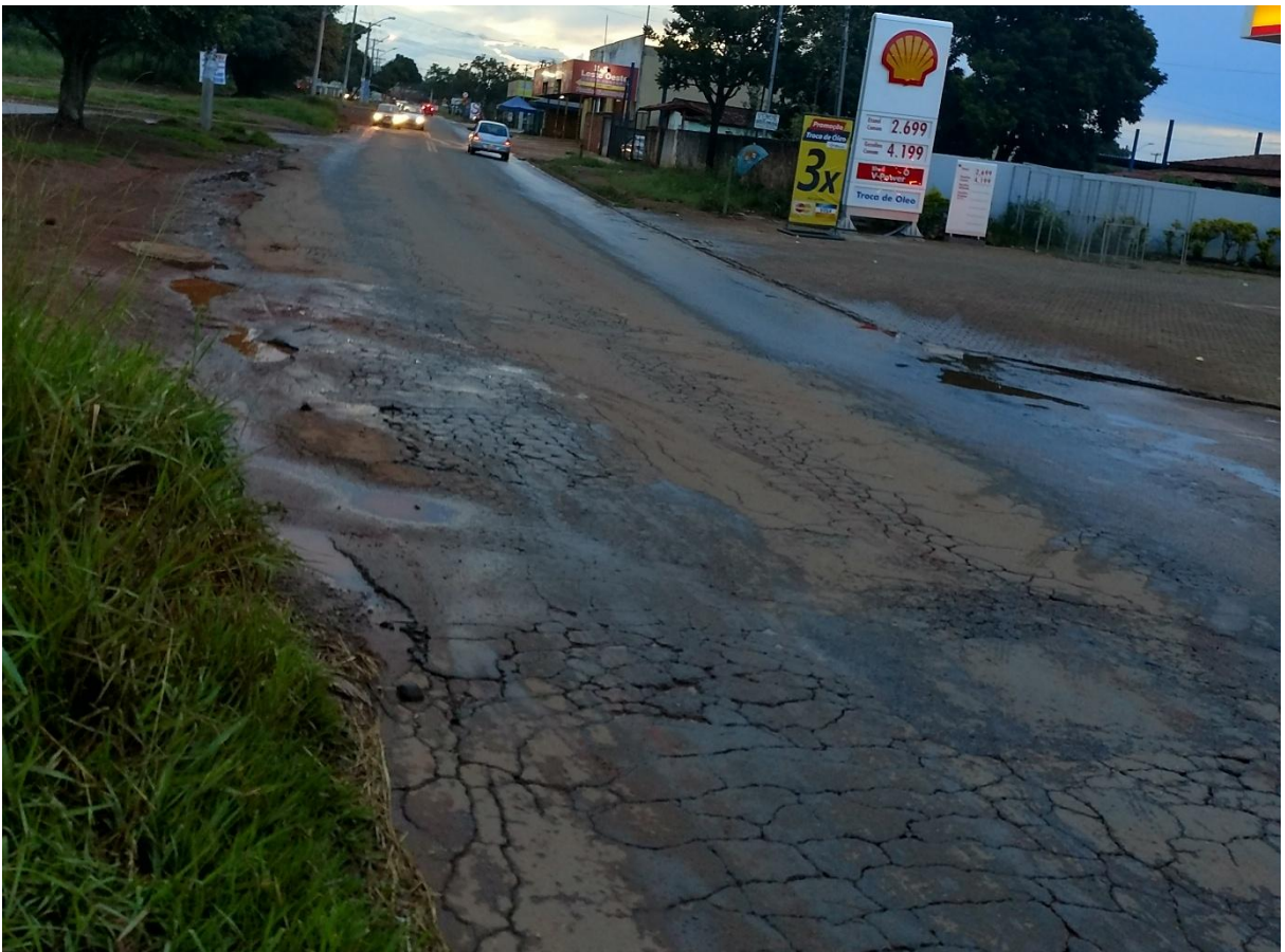
Figura 06: Patologias no pavimento.
