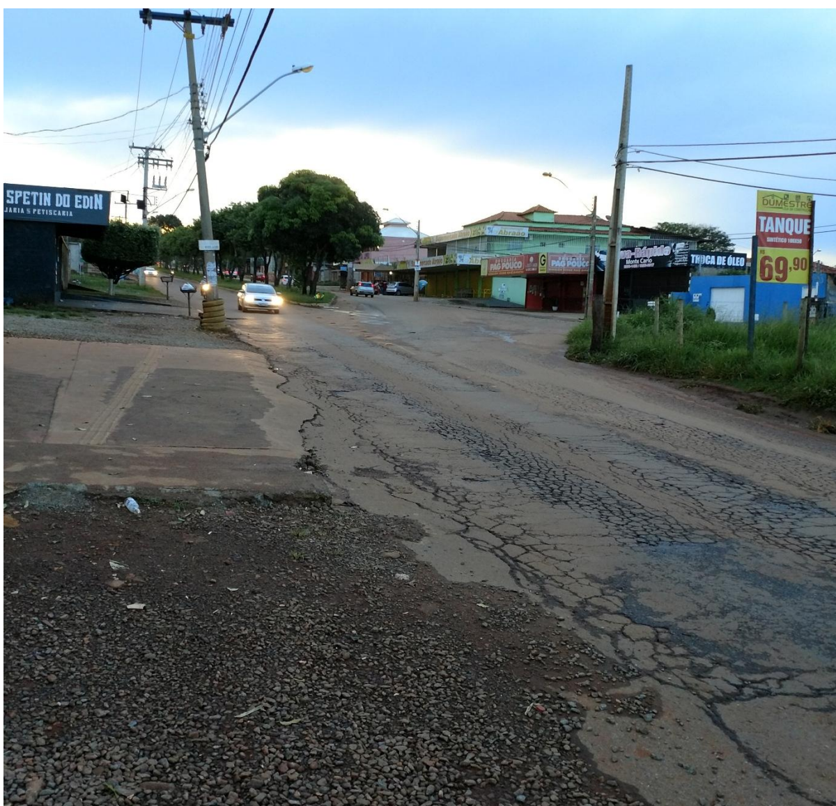
Figura 15: Ausência parcial de calçadas.
