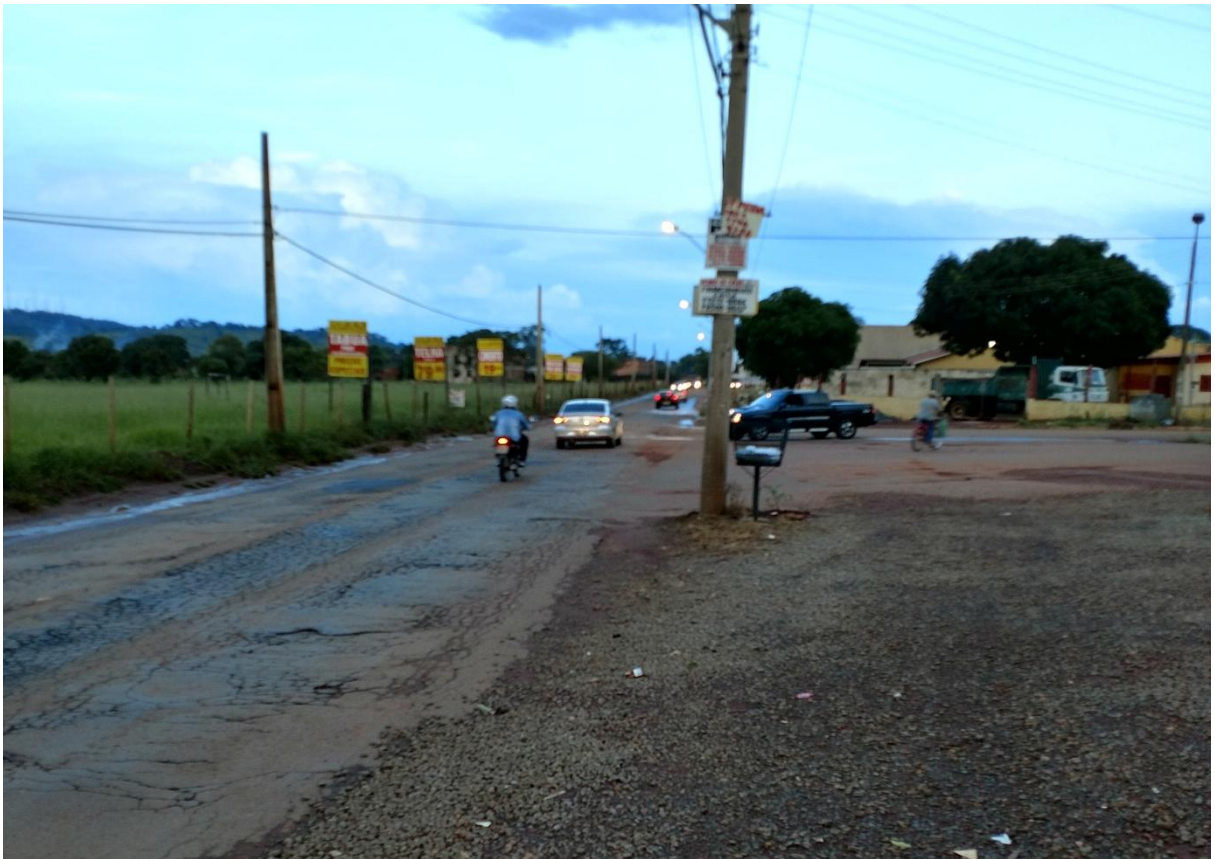
Figura 13: Patologias no pavimento.
