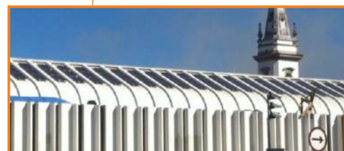
Figura 18: Placas Fotovoltaicas Cobertura Fonte: Biblioteca Parque, 2015.
