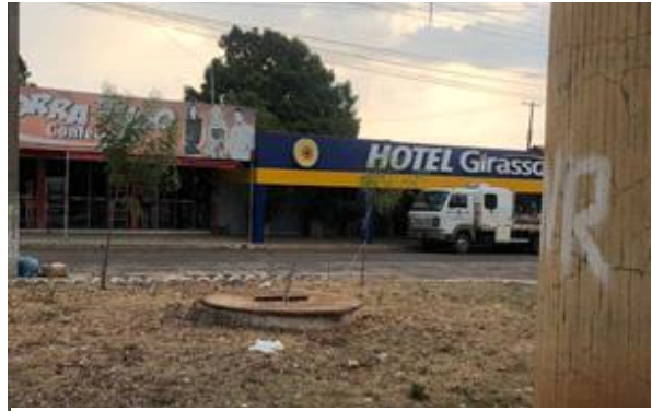
Figura 59: Poço com tampa quebrada. Fonte: Arquivo pessoal.
