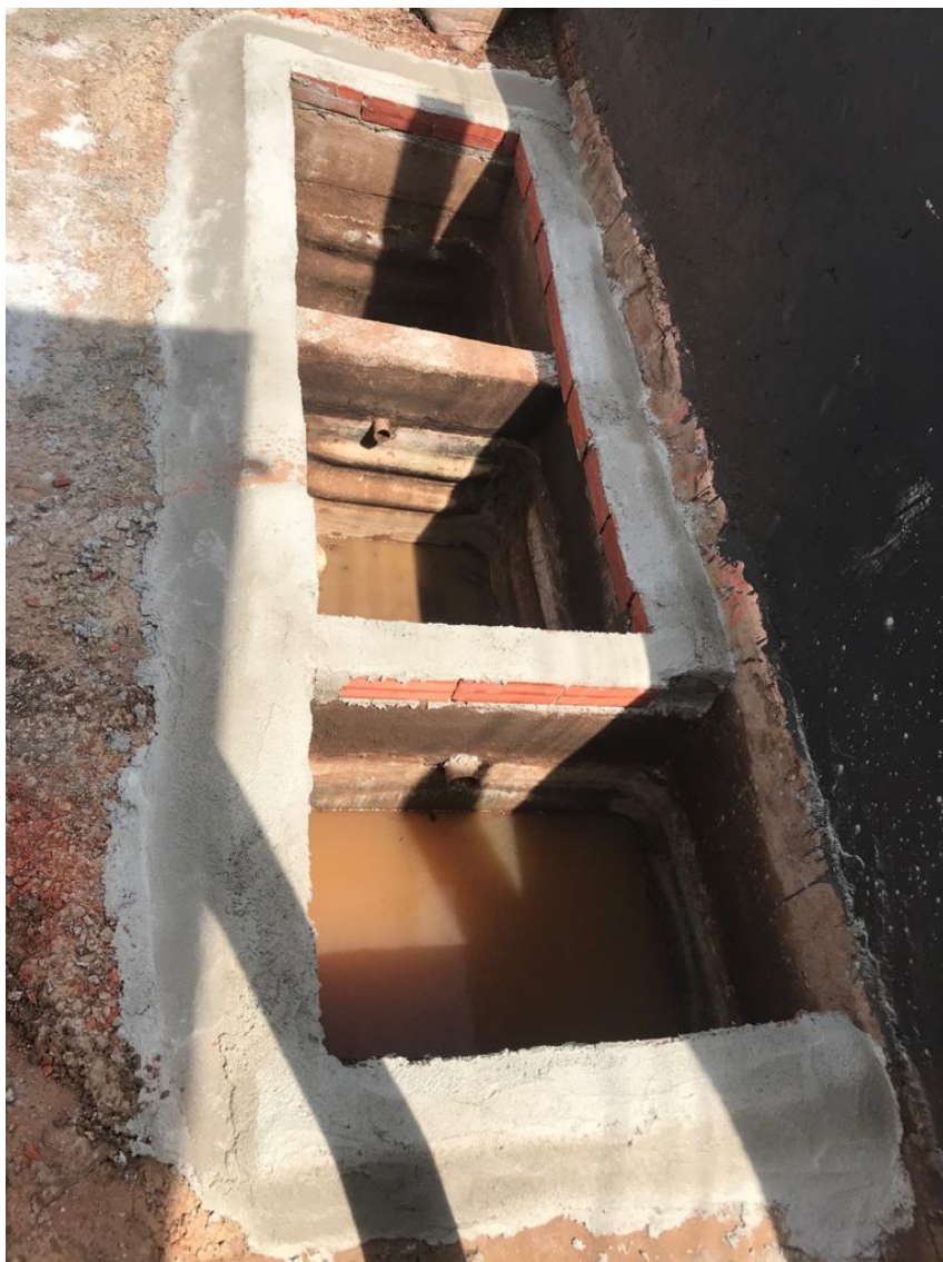
Figura 2 - Caixas de separação de água e óleo.
