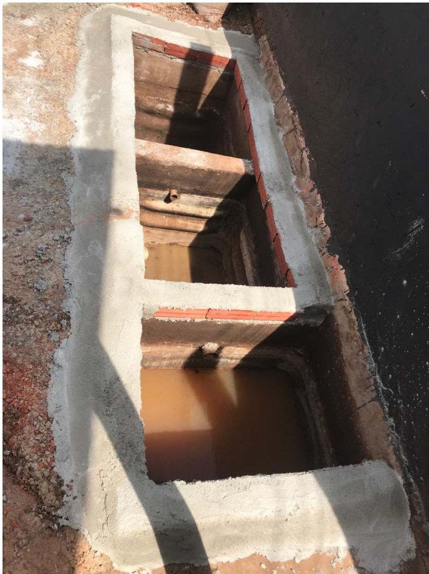
Figura 2 - Caixas de separação de água e óleo.
