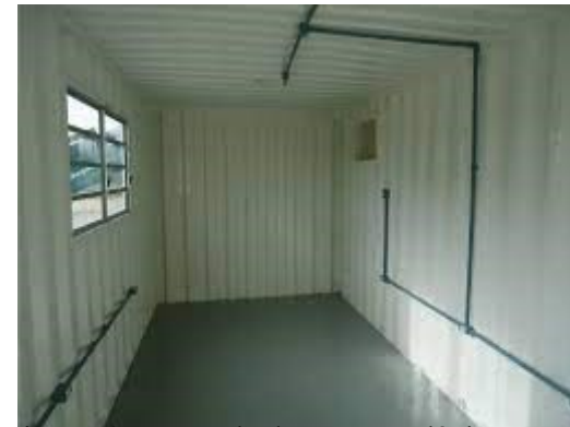
Figura 70 – Exemplo de estrutura elétrica no contêiner. Fonte: famguindastes.com.br, 2022
