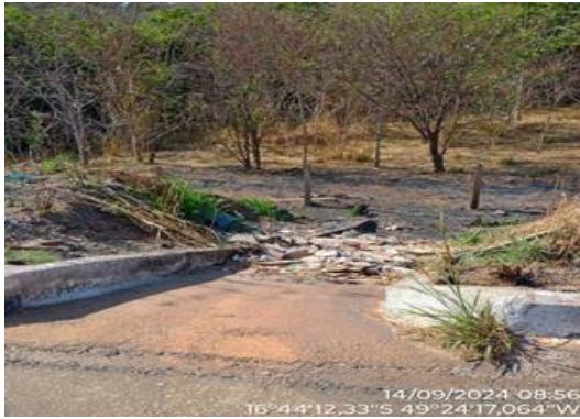
Figuras 21 e 22. Ponto 11, Sarjeta danificada acumulo resíduos da construção civil.
