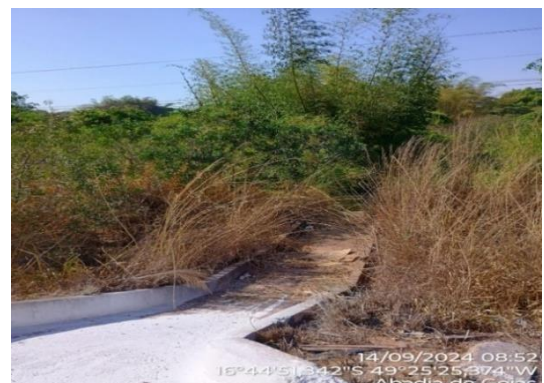
Ponto 14. Necessidade de manutenção ou limpeza.
